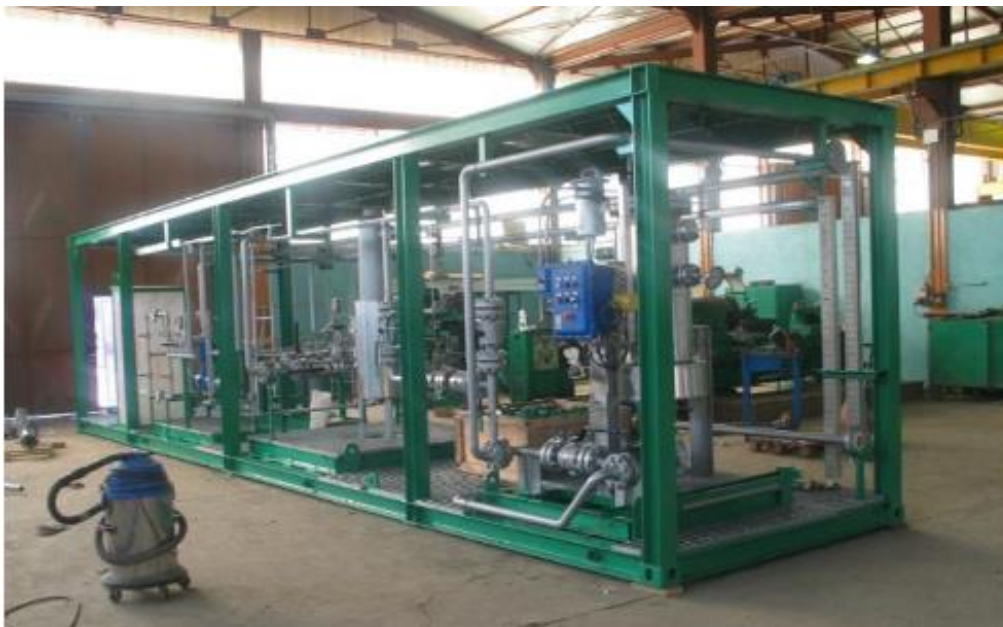
Figura 4. Esempio di struttura metallica autoportante con le apparecchiature di produzione e le relative strumentazioni.
