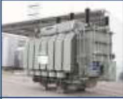
31,5/40 MVA 120/22 kV ONAF
