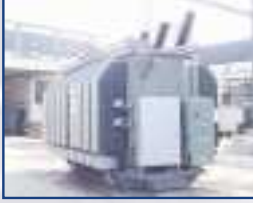
40 MVA 115/21 kV ONAF
