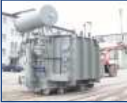
28 MVA 24/1,1 kV OFWF
