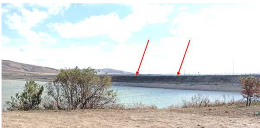
Figura 4.3 Paramento di monte della diga. Le frecce indicano la presenza di vegetazione tra le piastrelle del paramento di monte.
