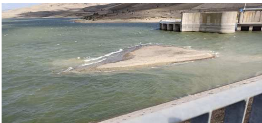
Figura 4.4. Sedimenti accumulati in corrispondenza del paramento di monte.
