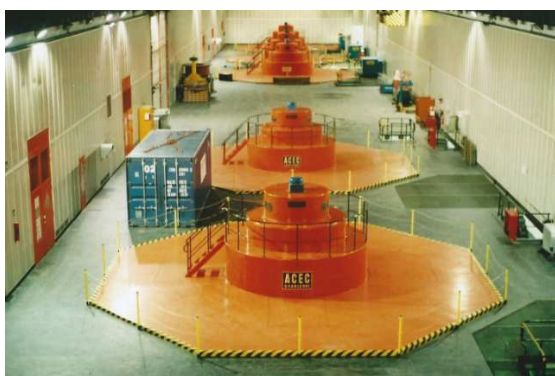
Figura 7.14. L'interno di una centrale di produzione a pompaggio interrata nelle Alpi da cui si apprezzano le dimensioni e gli ingombri delle macchine.
