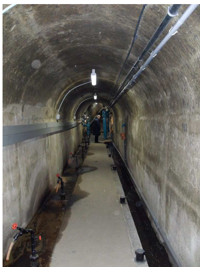
Figura 7.5. Esempio di cunicolo di ispezione messo in opera.
