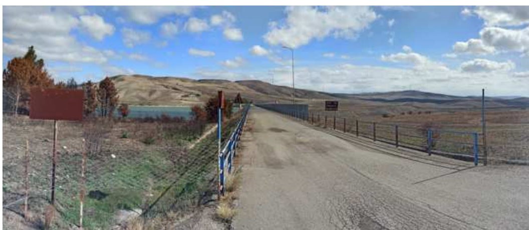
Figura 4.5. Stato di abbandono di recinzioni, cartellonistica, vegetazione e strada visibilmente ammalorata.
