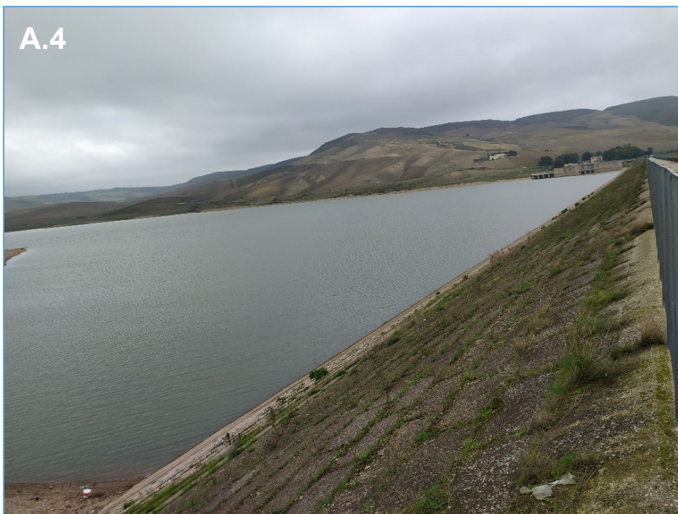
Figura 6. Il paramento di monte della diga del Basentello a servizio dell'invaso irriguo di Serra del Corvo.
