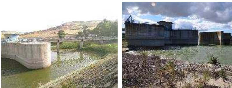
Figura 31. Zone degradate nei pressi delle opere esistenti esercitate da EIPLI.
