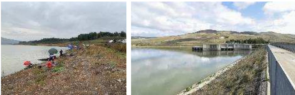
Figura 32. Alcuni tratti litorali degradati e il paramento di monte della diga di Serra del Corvo.
