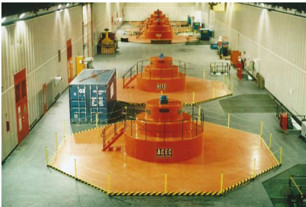
Figura 16. L'interno di una centrale di produzione a pompaggio interrata nelle Alpi da cui si apprezzano le dimensioni e gli ingombri delle macchine.
