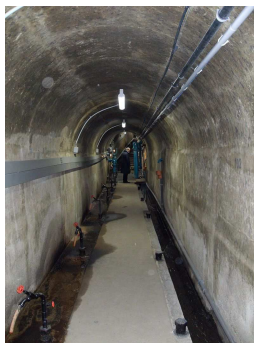
Figura 10. Esempio di cunicolo di ispezione messo in opera.
