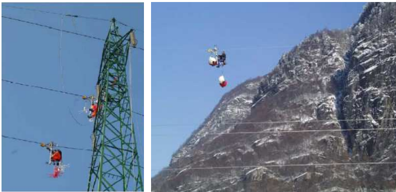
Figura 10. Esempi di dispositivi a sfera installati sulle linee ad alta tensione in ambito montano.
