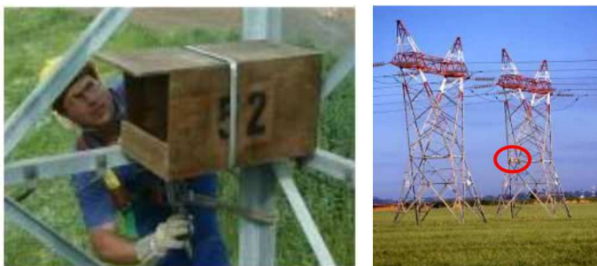
Figura 11. Esempi di nidi artificiali per l'avifauna installabili nel terzo medio ed inferiore dei tralicci del nuovo elettrodotto.
