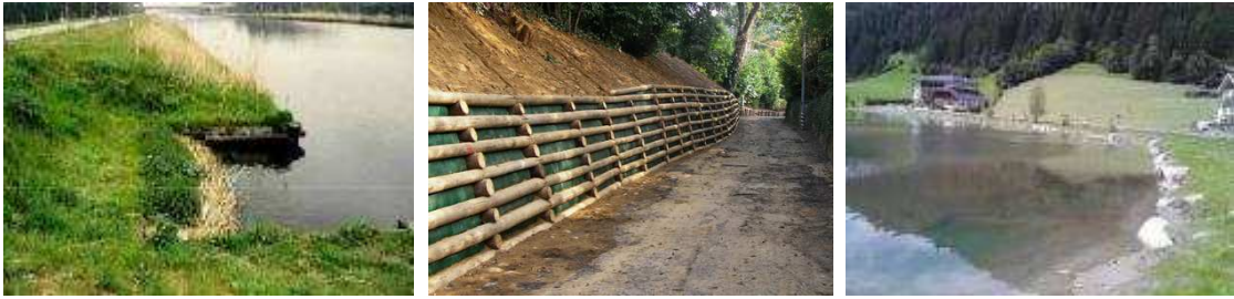
Figura 15. Le sistemazioni ed i consolidamenti spondali saranno gestiti in modo armonico e naturalistico per non inficiare il contesto ambientale di riferimento.
