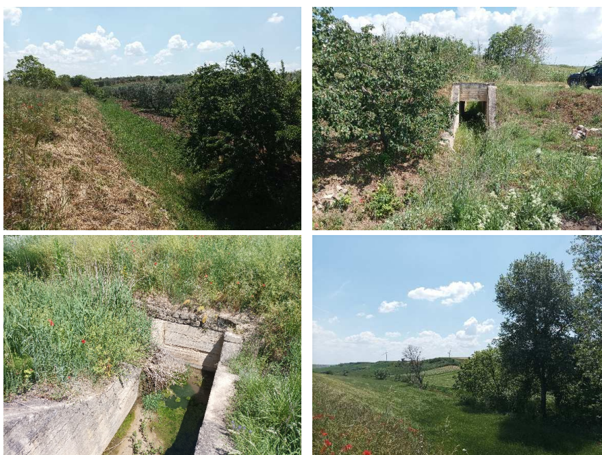
Figura 4. Alcune immagini del fossato afferente al bacino imbrifero del torrente Pentecchia.
