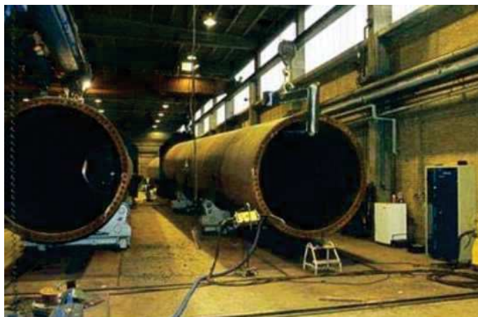
Figura 11 - torri in acciaio
