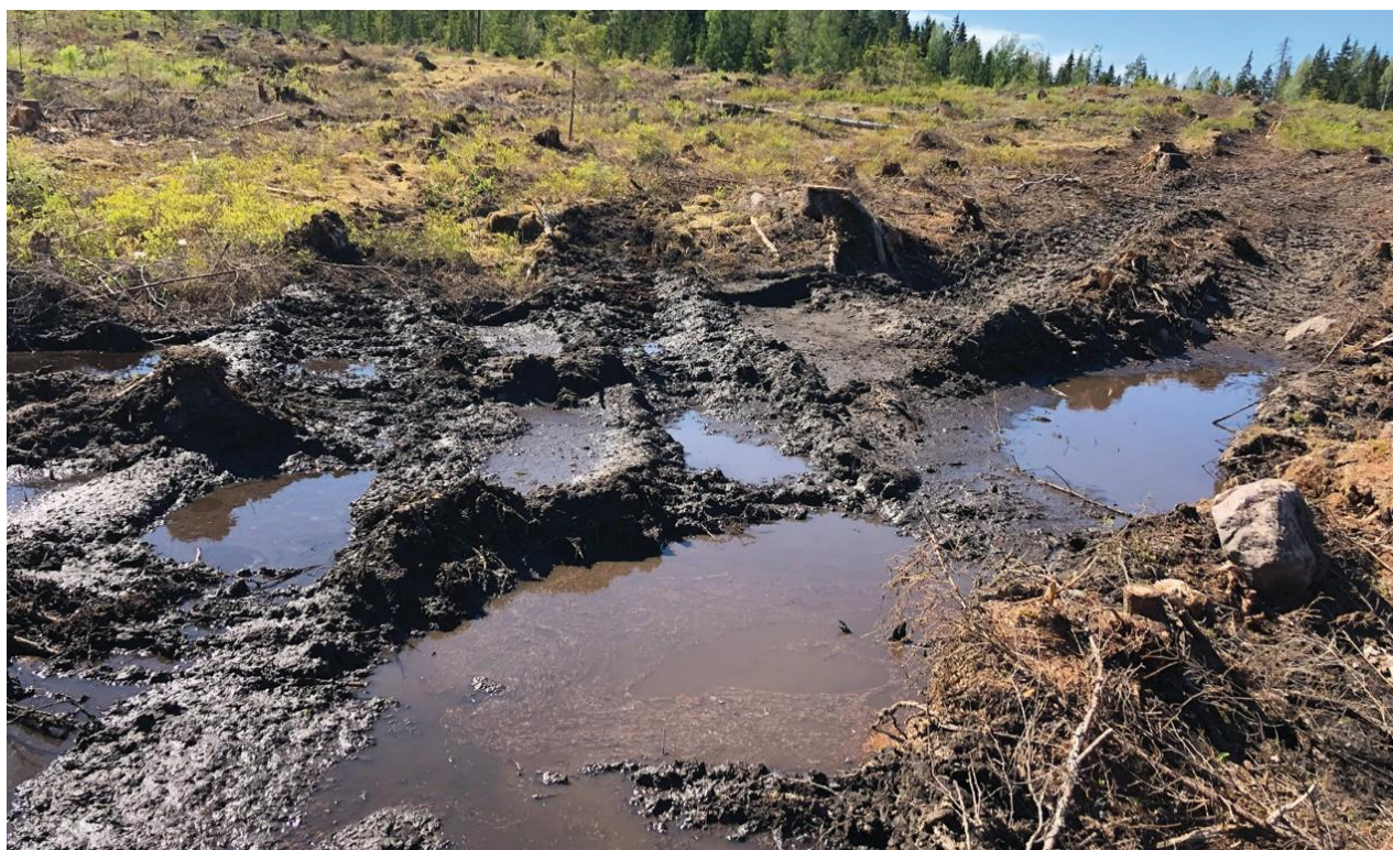
Figura 6: Formazione di solchi causata dal passaggio di macchine da cantiere. In seguito ad eventi meteorici si possono formare importanti ristagni idrici
