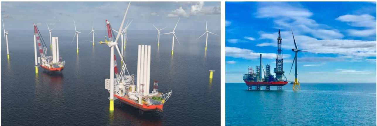
Figura 27 – esempio di installazione offshore (fonte: cadeler.com)
