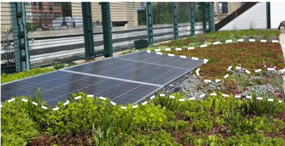
Esempio di integrazione tra i pannelli fotovoltaici e la copertura a verde e ghiaia
