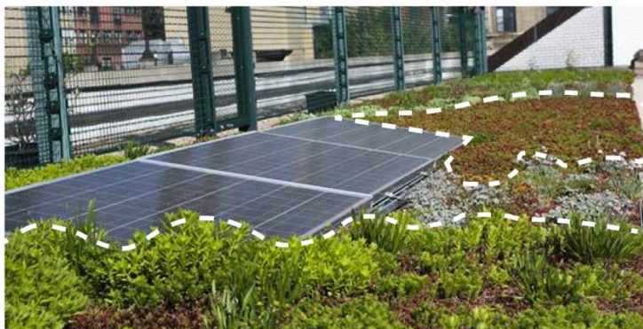
Esempio di integrazione tra i pannelli fotovoltaici e la copertura a verde e ghiaia
