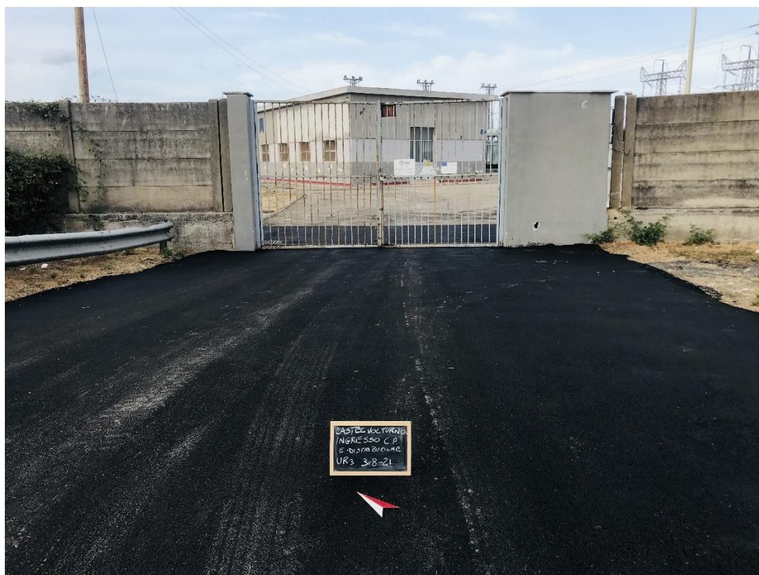
Fig. 36 - Dettaglio della Cabina Primaria e-distribuzione.
