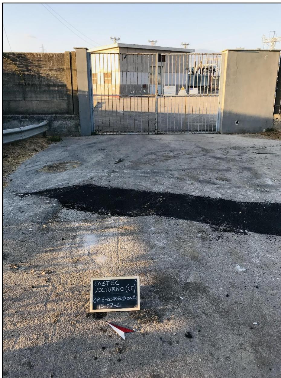
Fig. 37 - Dettaglio della Cabina Primaria e-distribuzione.
