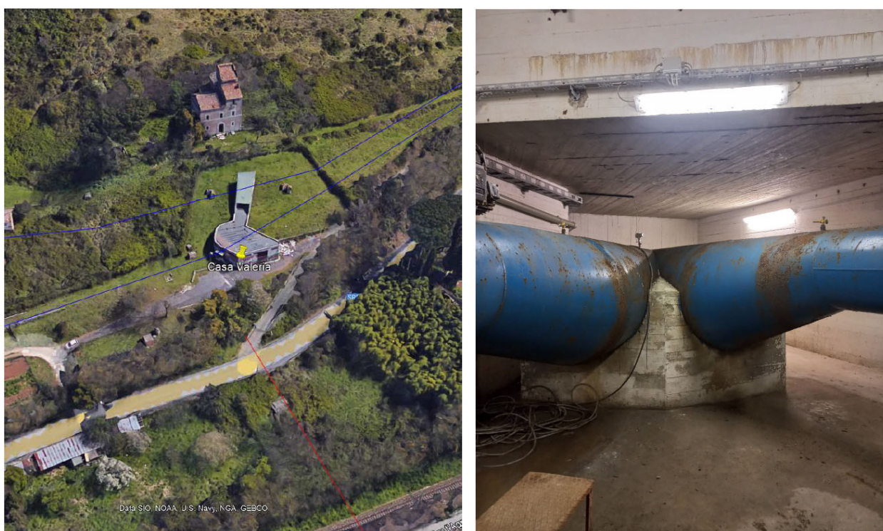
Figura 3.2 – C.I. Casa Valeria, forchetta DN1200 mm e DN1000 mm che si unisce nell'VIII Sifone esistente
