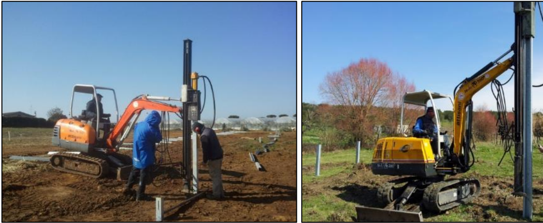
Figura 35 - Tipologia di installazione delle strutture di sostegno dei moduli FTV con macchina battipalo
