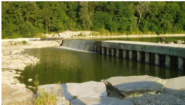
Figura 8 - Traversa realizzata nel 2002, definitivamente crollata nel 2010.
