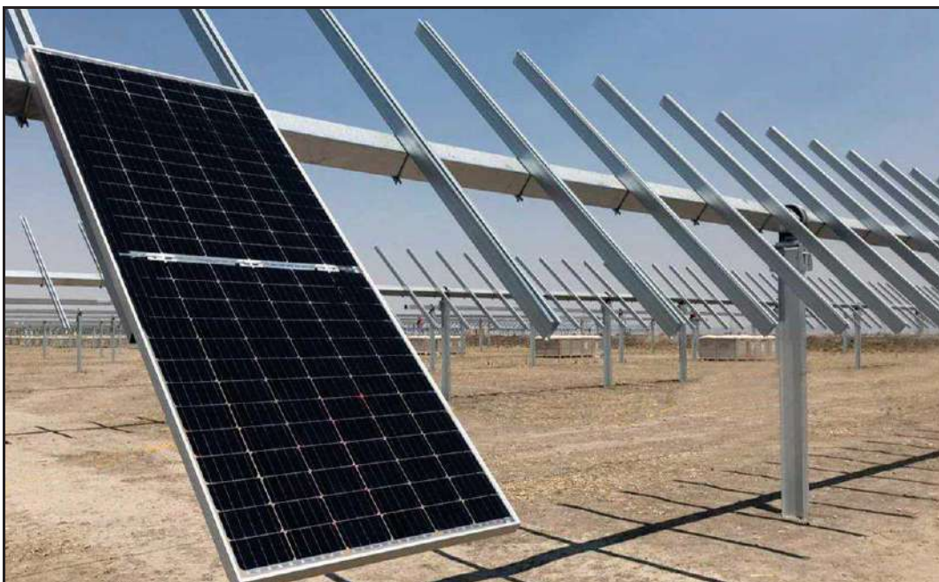
Figura 6 – esempio di tracker fotovoltaico
