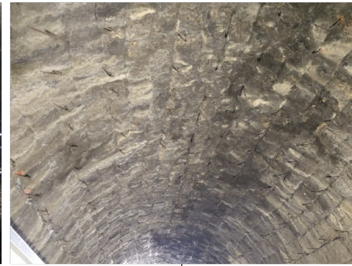
Rivestimento in bognini con iniezione di resine e umidità
