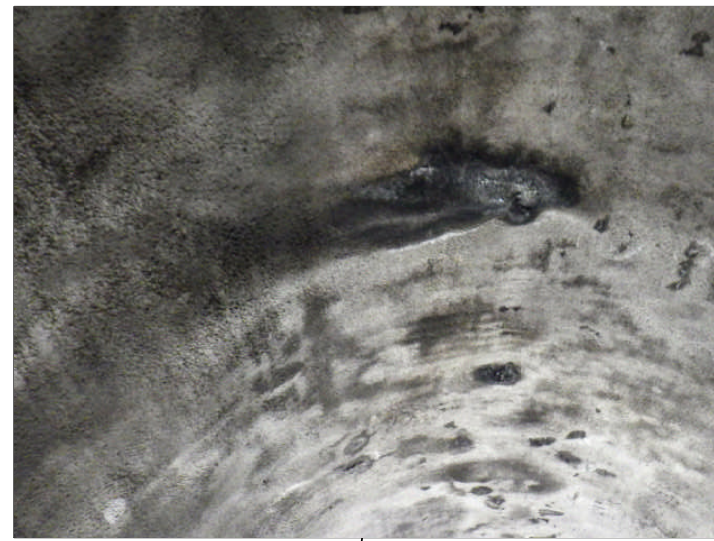
Rivestimento in spritz beton/gunite con venuta d'acqua
