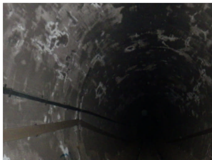
Rivestimento in spritz beton/gunite con umidità
