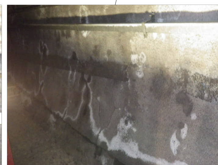
Rivestimento in spritz beton/gunite con umidità
