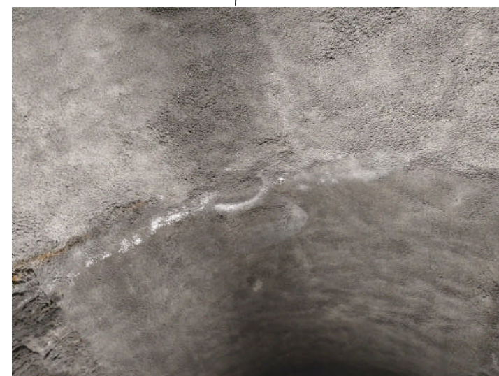
Rivestimento in spritz beton/gunitite con umidità
