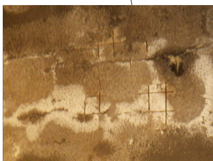
Rivestimento in spritz beton/gunite con armatura esposta
