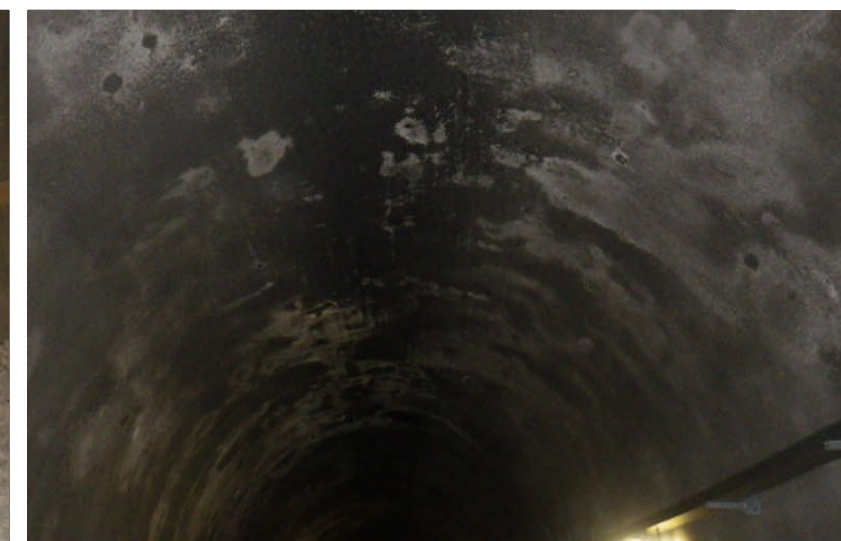
Rivestimento in spritz beton/gunite con umidità
