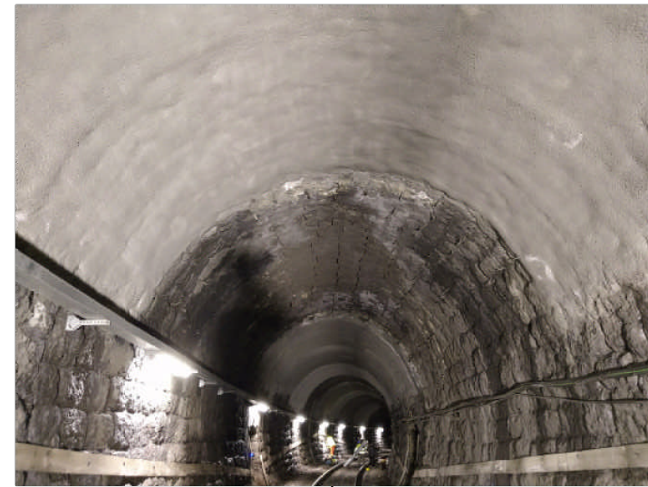
Umidità al limite del rivestimento in spritz beton/gunite
