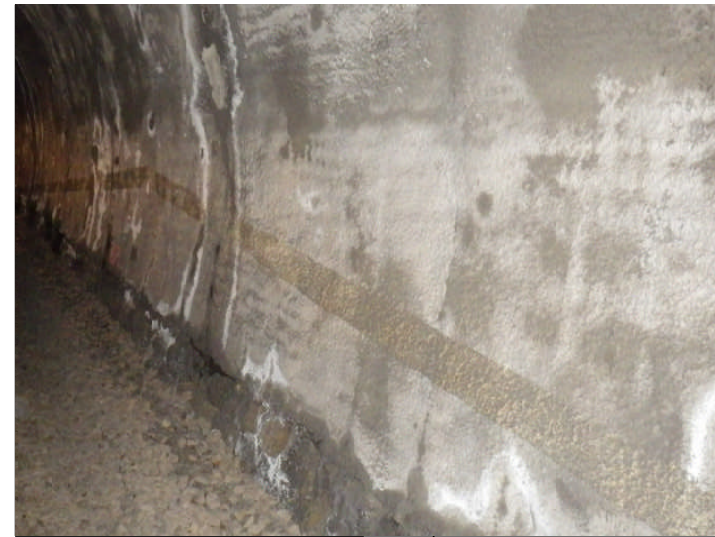
Rivestimento in spritz beton/gunite con umidità
