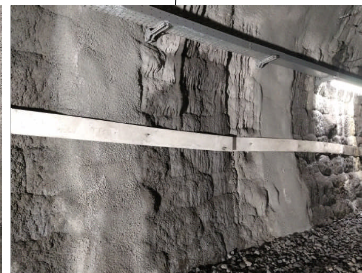
Rivestimento in bolognini con concrezioni e ripristino in calcestruzzo
