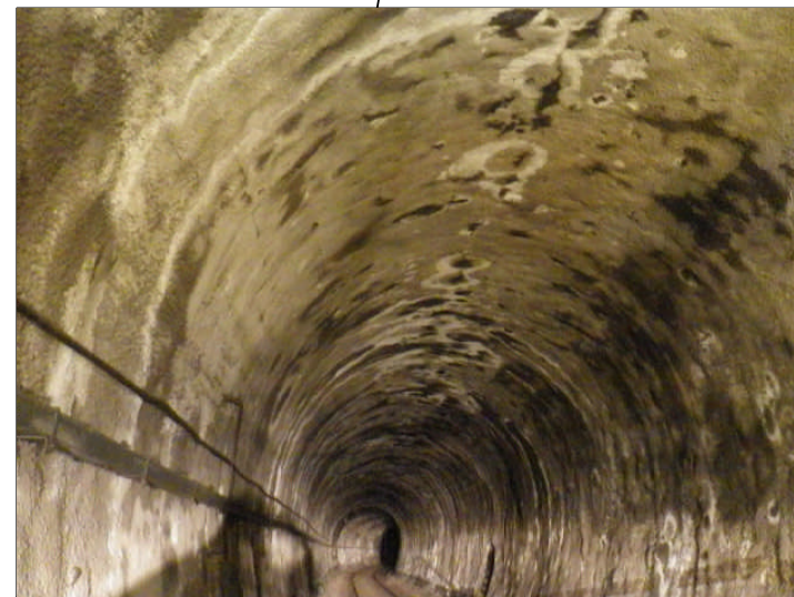
Rivestimento in spritz beton/gunite con umidità
