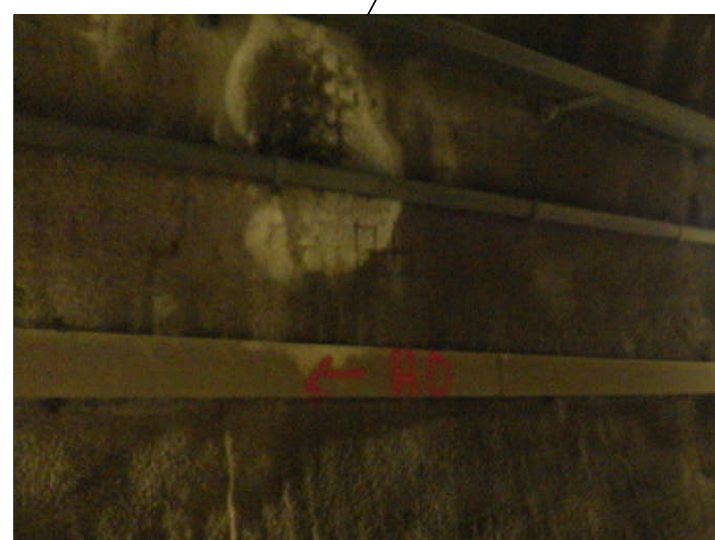
Rivestimento in spritz beton/gunite con umidità
