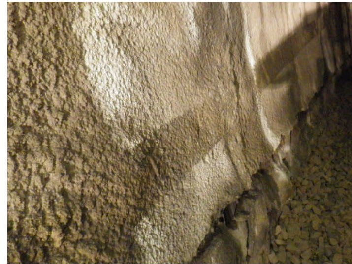
Rivestimento in spritz beton/gunite con umidità
