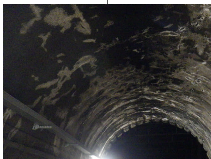
Rivestimento in spritz beton/gunite con umidità
