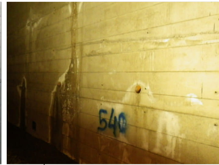
Galleria artificiale in calcestruzzo armato con umidità
