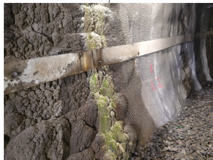
Ripristino in calcestruzzo con presenza di muschio
