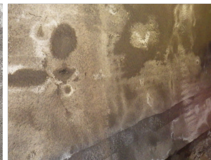
Rivestimento in spritz beton/gunite con umidità
