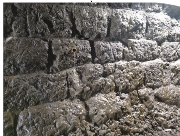
Rivestimento bognini con venute d'acqua e dreno attivo
