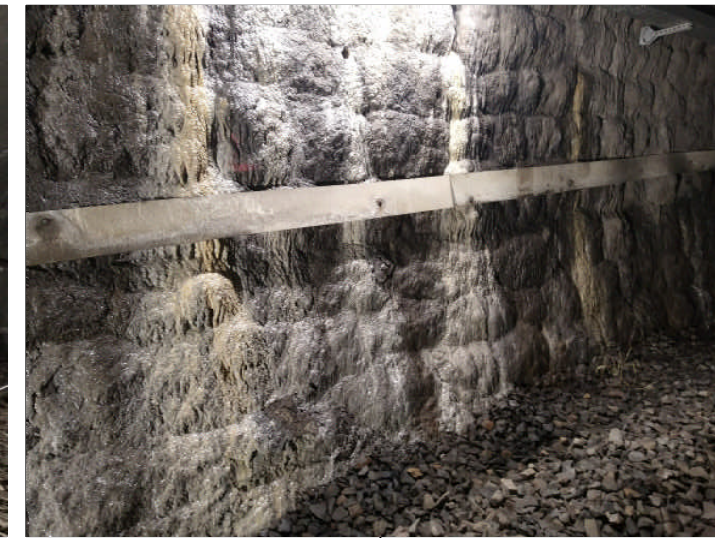
Rivestimento bolognini con umidità e concrezioni
