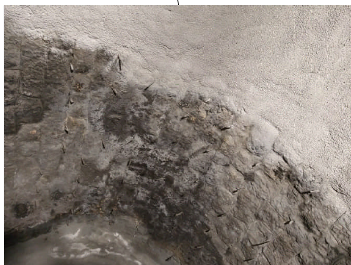
Rivestimento bolognini con umidità
