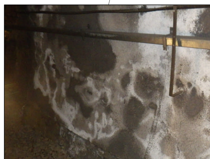
Rivestimento in spritz beton/gunite con umidità
