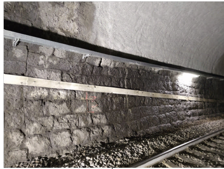
Rivestimento in bognini con venuta d'acqua
