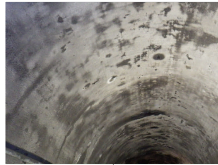
Rivestimento in spritz beton/gunite con umidità
