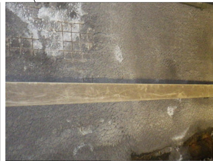
Rivestimento in spritz beton/gunite con armatura esposta
