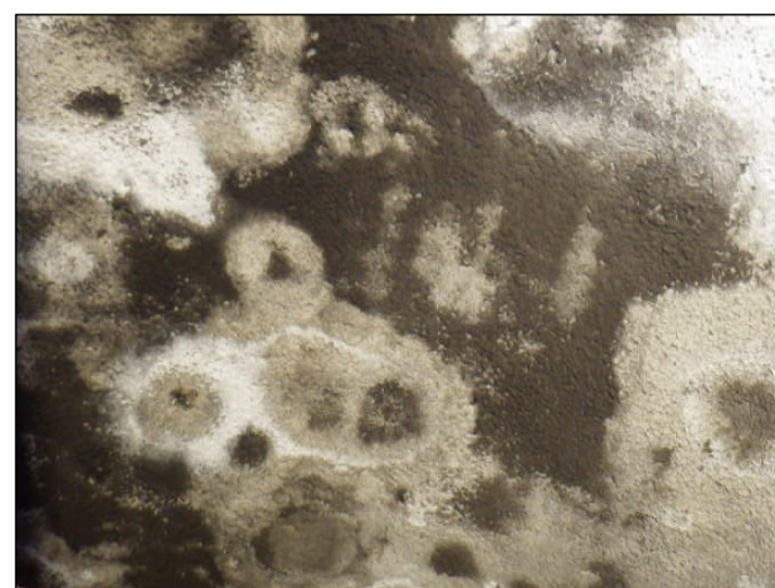
Rivestimento in spritz beton/gunite con umidità
