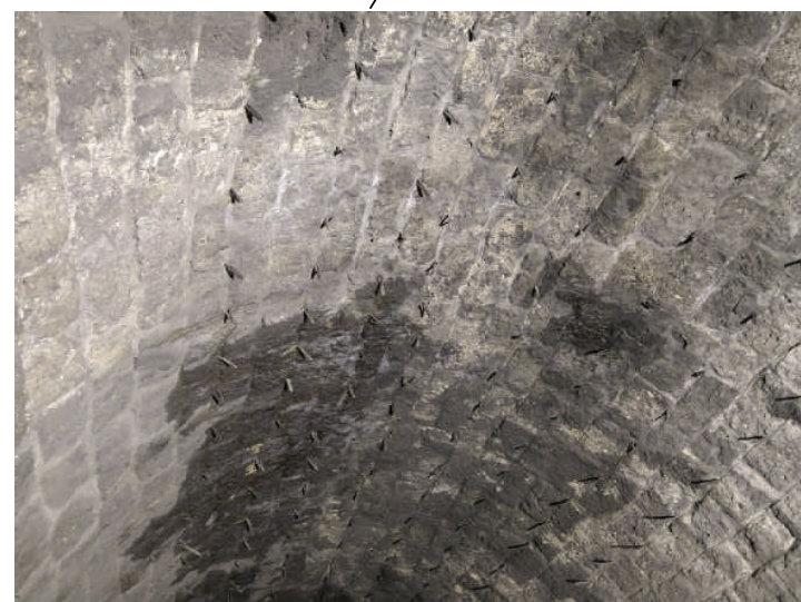
Rivestimento in bognini con venuta d'acqua
