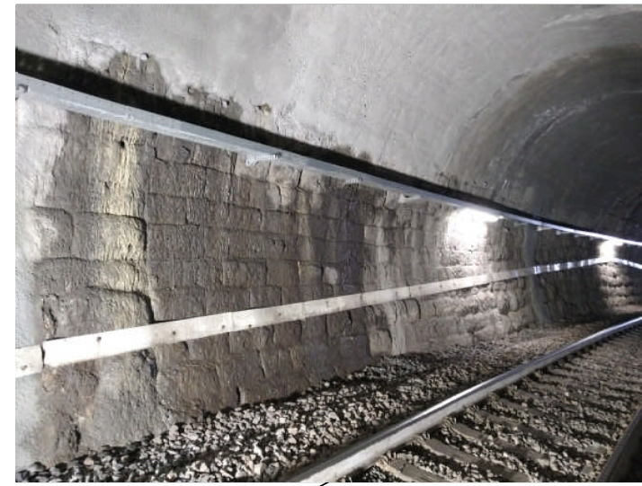
Rivestimento in bognini con umidità, concrezioni e venute d'acqua
