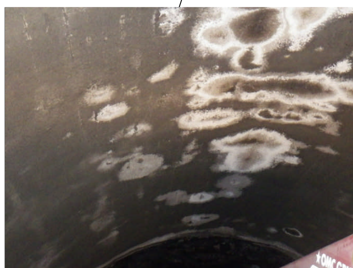
Rivestimento in spritz beton/gunite con umidità
