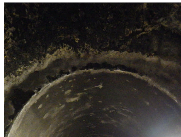
Rivestimento in spritz beton/gunite con umidità
