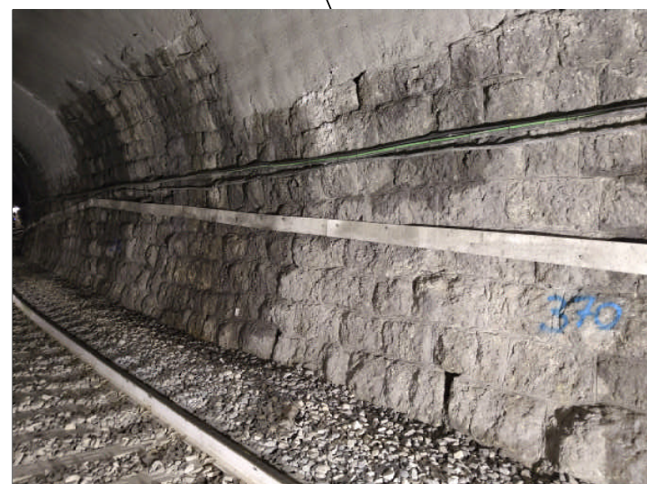
Rivestimento bognini con venute d'acqua
