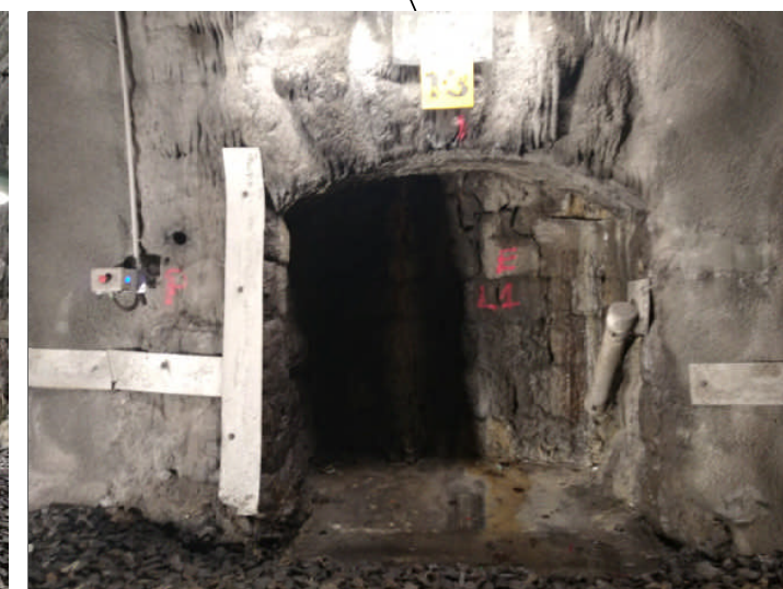
Nicchia 13 con umidità e concrezioni
