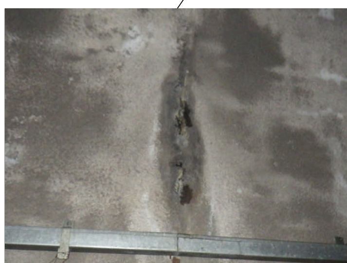
Rivestimento in spritz beton/gunite con lesione
