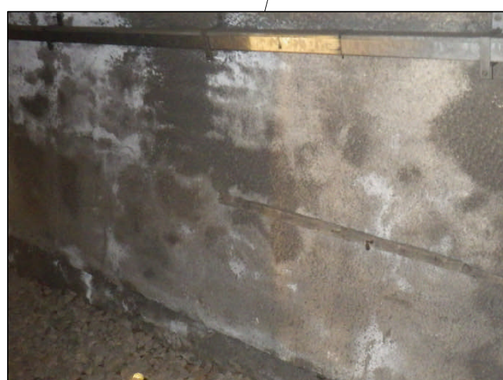
Rivestimento in spritz beton/gunite con umidità
