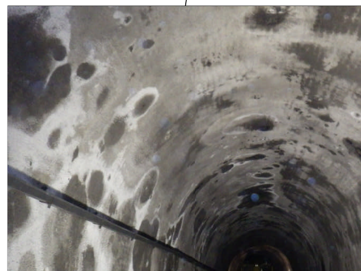
Rivestimento in spritz beton/gunite con umidità
