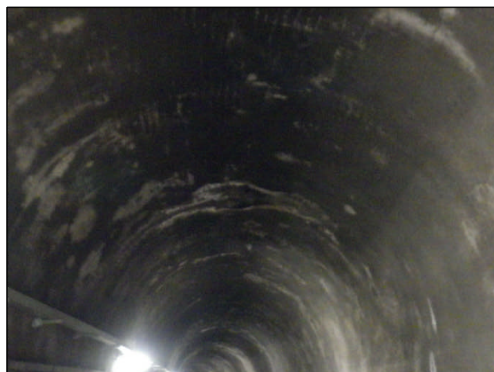
Rivestimento in rivestimento in spritz beton/gunite con umidità
