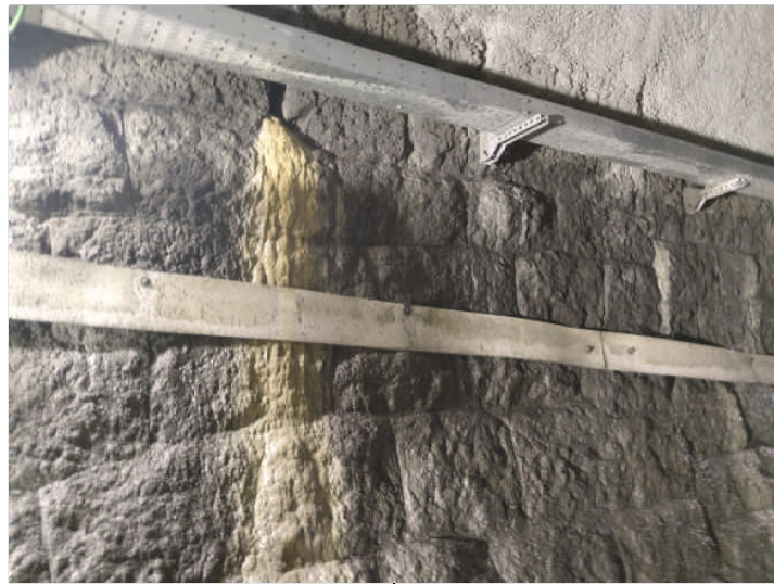
Concrezioni sul piedritto
