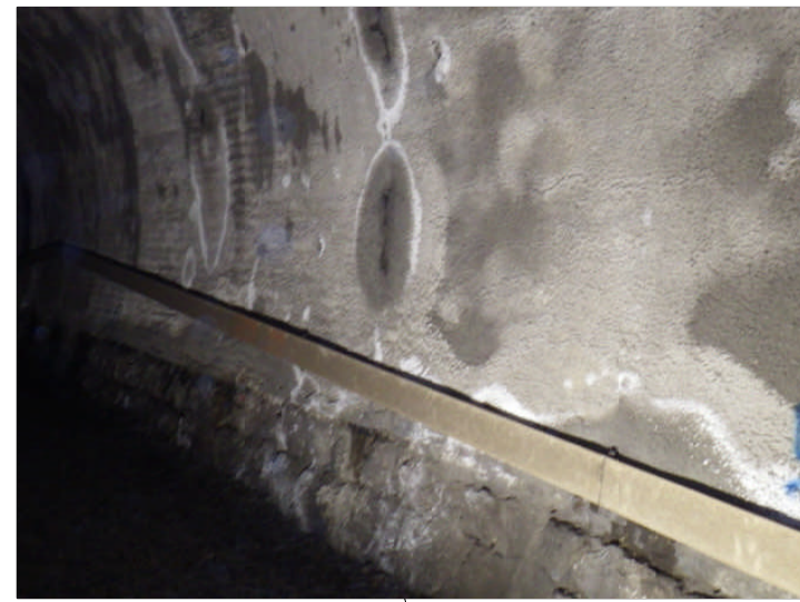
Rivestimento in spritz beton/gunite con umidità
