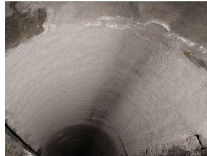
Rivestimento in spritz beton/gunitite con umidità
