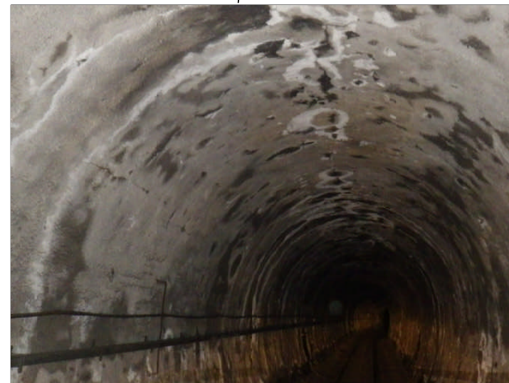
Rivestimento in spritz beton/gunite con umidità
