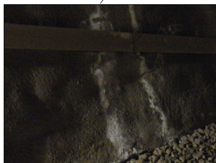
Rivestimento in spritz beton/gunite con umidità
