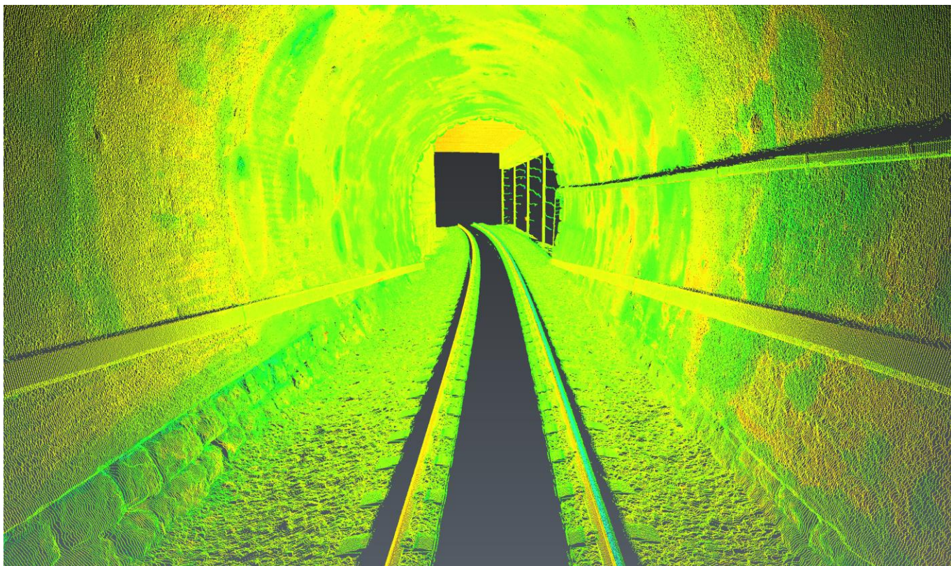
Figura 15. Galleria Malpensada: rivestimento in spritz beton e transizione con GA in uscita (laser scanner)
