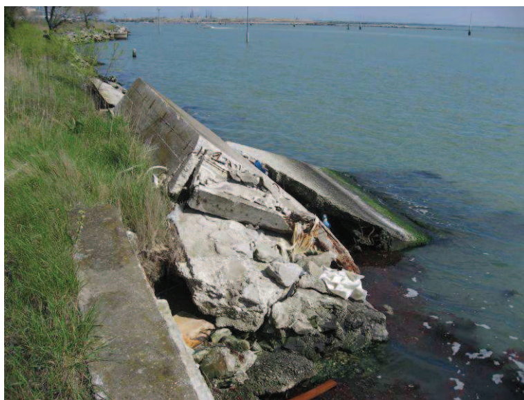
Figura 2-10 Attacco a terra del pontile di attracco semidemolito
