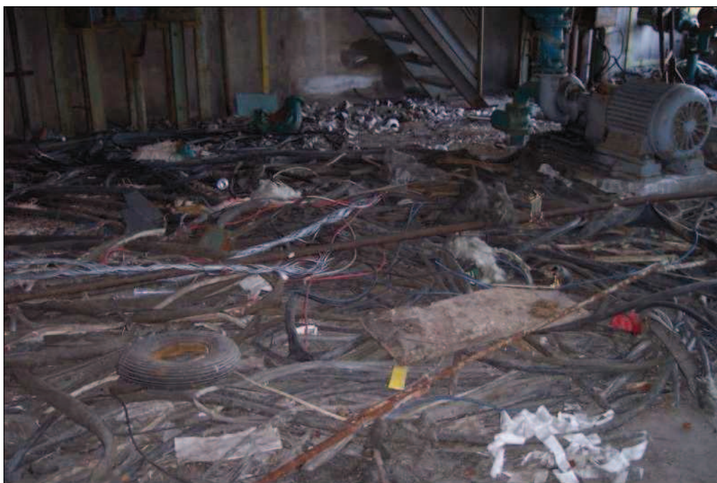
Figura 3-5 Centrale termoelettrica – interno
