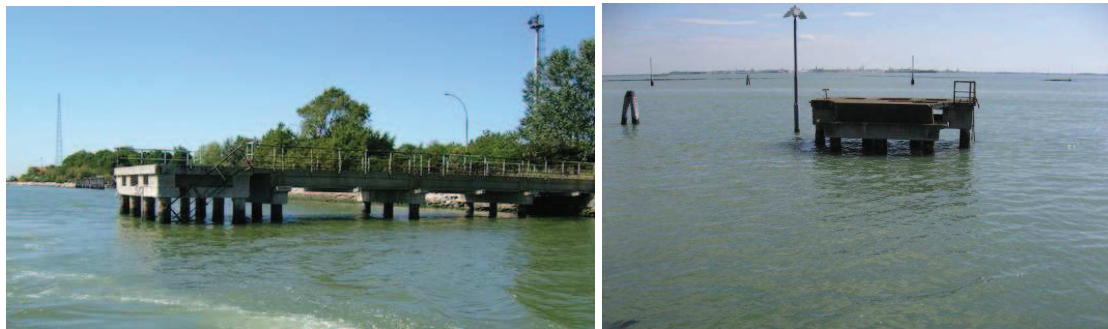
Figura 2-9 Pontile di attracco a sinistra come appariva prima del crollo e a destra come appare oggi, semidemolito
