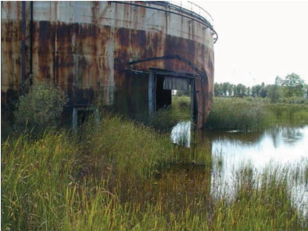
Figura 3-6 Serbatoi per lo stoccaggio di nafta per l'alimentazione della centrale termoelettrica
