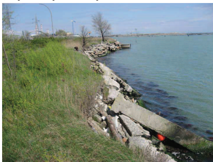
Figura 2-7 Scarpa del canale S. Leonardo-Marghera – deposito di detriti alla rinfusa
