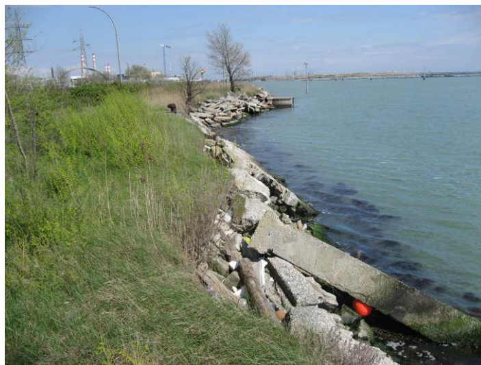
Figura 2-3 Scarpata del canale S. Leonardo - Marghera – deposito di detriti alla rinfusa
