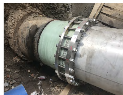
Tubazione con giunto e tubo INOX
