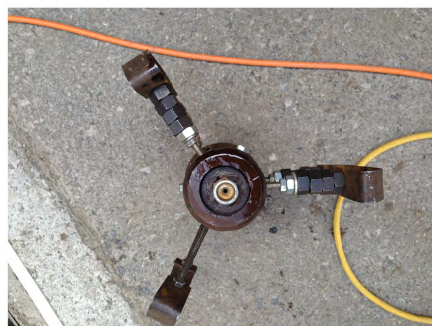
Impianto di idropulizia
