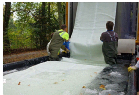
Raffreddamento liner in vasca d'acqua
