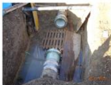
Tubazioni con giunti da collegare
