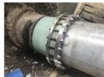
Tubazione con giunto e tubo INOX
