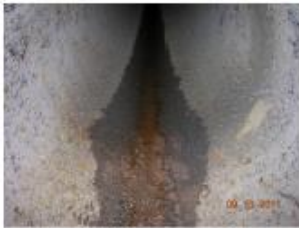
Immagine canale prima del risanamento
