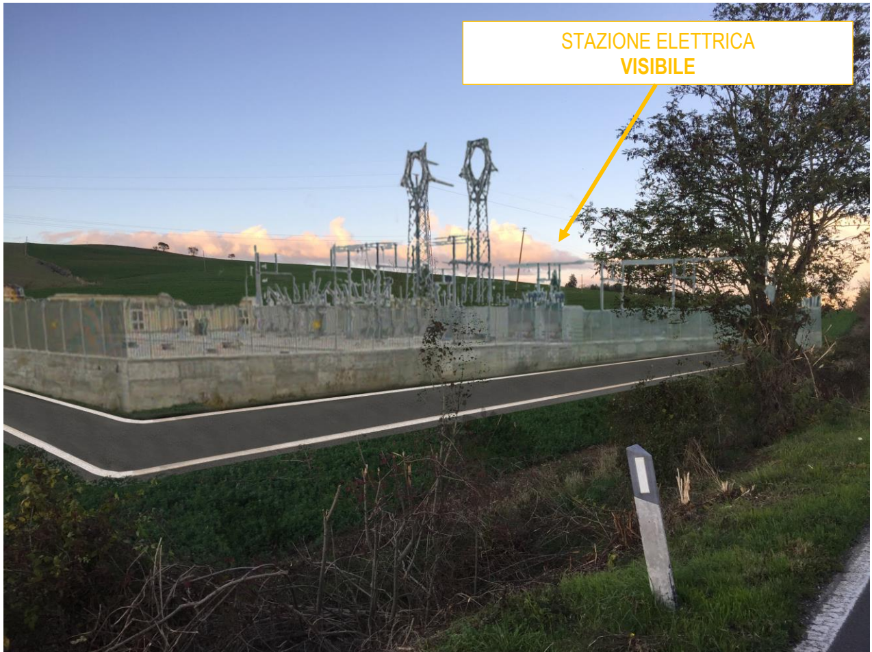
Foto 35: Visuale 21 – Stazione Elettrica TERNA SPA
