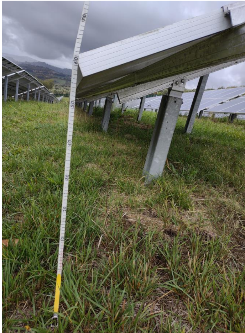
Impianto Francavilla D'Ete. Altezza Minima e vegetazione diradata sotto ai pannelli
