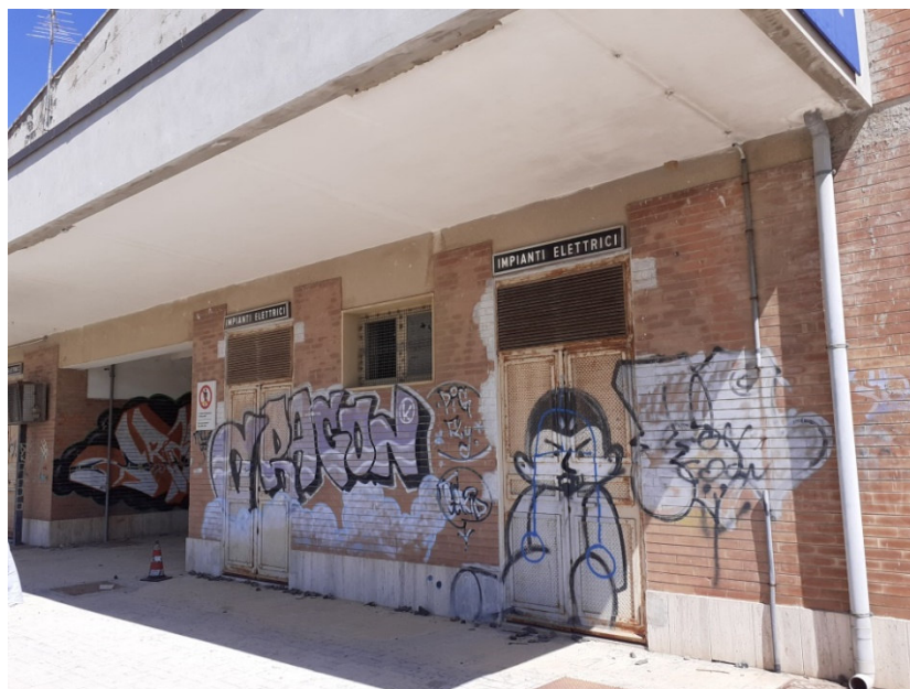
Figura 5.3 - Locali degli impianti elettrici della stazione di Niscemi (foto sopralluogo 2020)
