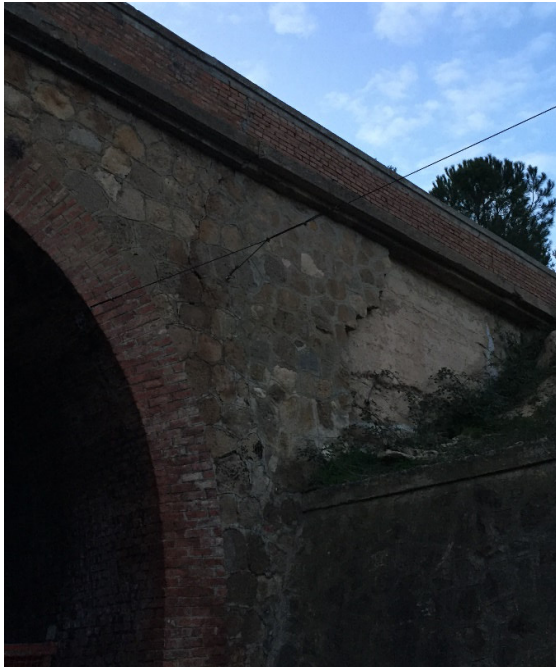
Figura 17: Lesione e distacco del rivestimento
