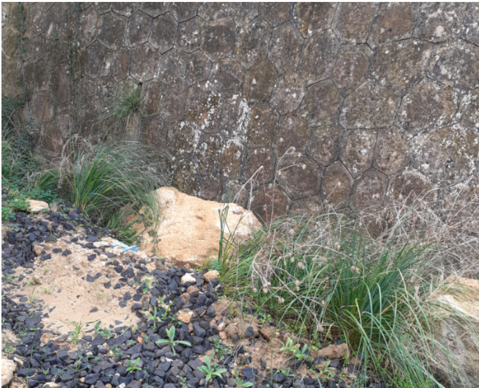
Figura 2.6 Smottamenti imbocco Galleria San Nicola Noce dovuti ad erosioni locali
