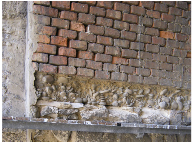
Figura 13: Degrado delle malte tra i mattoni della calotta e inerti di grandi dimensioni
