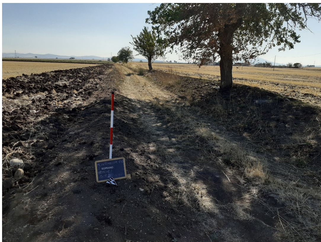
Foto 6: cavidotto interno, secondo tratto, vista da N
