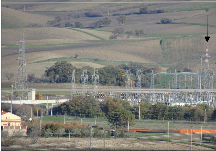
DETTAGLIO STAZIONE ELETTRICA TERNA
