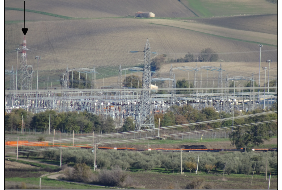
DETTAGLIO STAZIONE ELETTRICA TERNA
