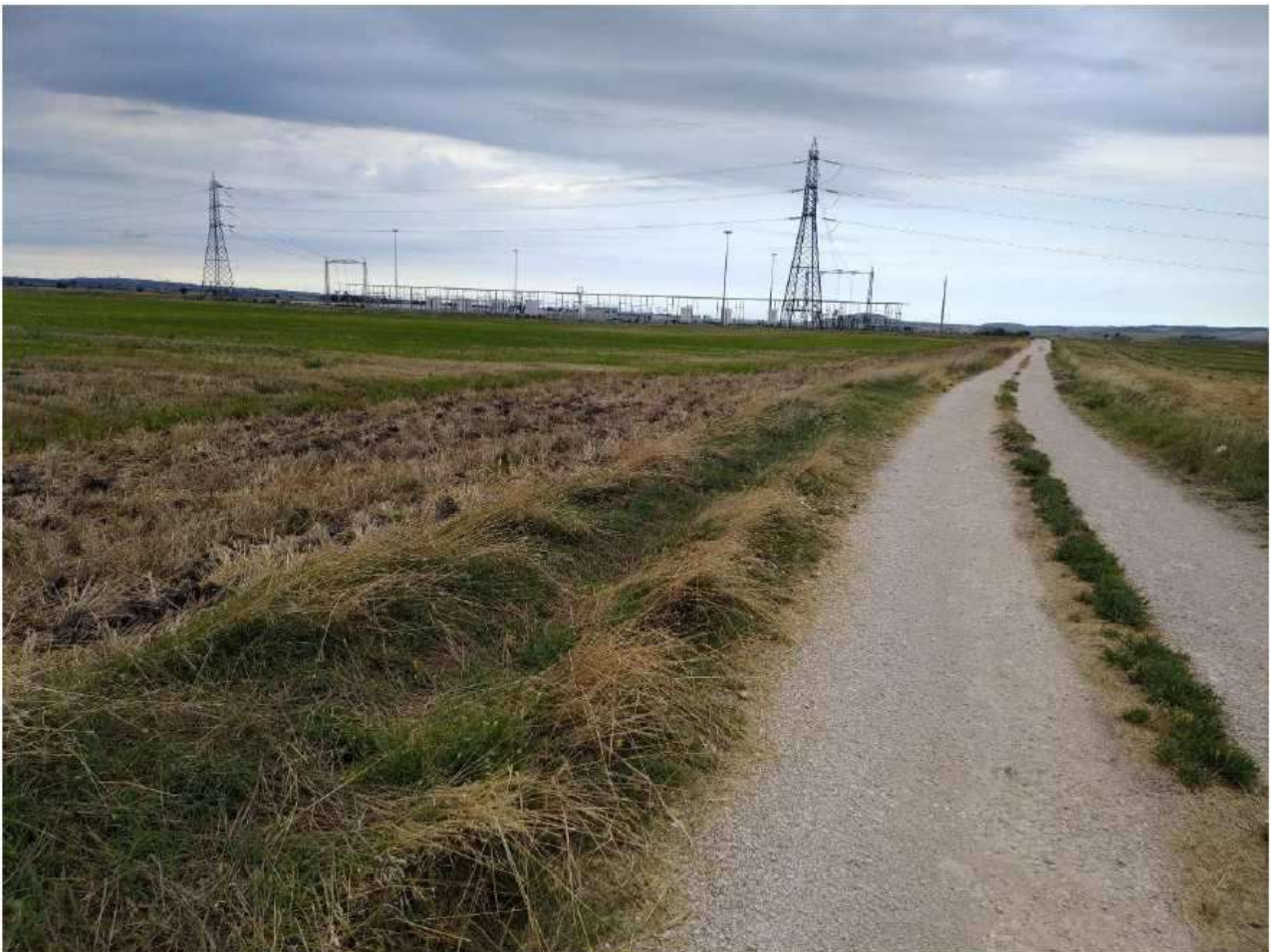
Stazione di Elevazione Foto 50
