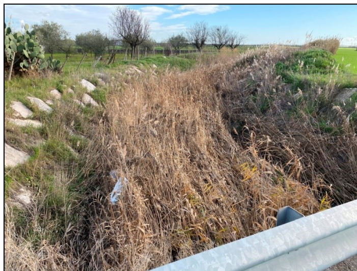
Figura 2.16 – Canale Santa Maria con sezione di deflusso molto ridotta a causa della presenza di fitta vegetazione in alveo.
