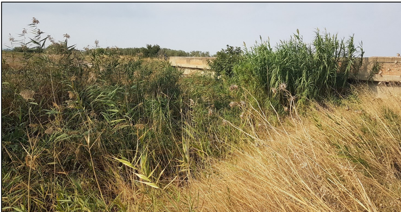
Fig.5.25 – Ponte sul Canale Santa Maria – Si evince chiaramente la scarsissima manutenzione, con l'alveo ingombro di vegetazione e a luoghi con tombamenti parziali e le sponde non presentano vegetazione stabilizzante arborea/arbustiva come in passato. A luoghi le sponde sono totalmente prive di vegetazione.
