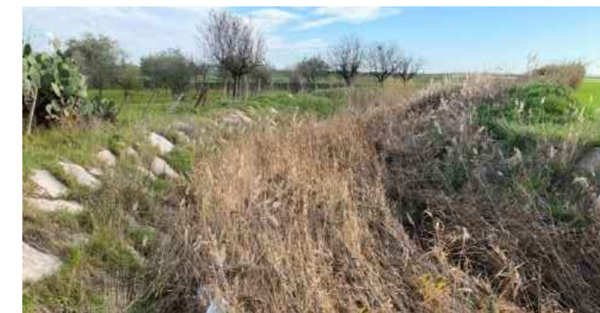
Canale Santa Maria Sezione di deflusso molto ridotta a causa della presenza di fitta vegetazione in alveo
