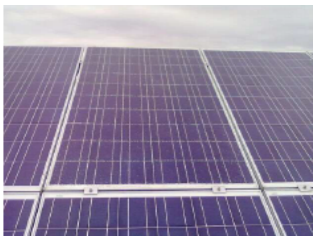
Tavola n. 21: Modulo con superficie compromessa
