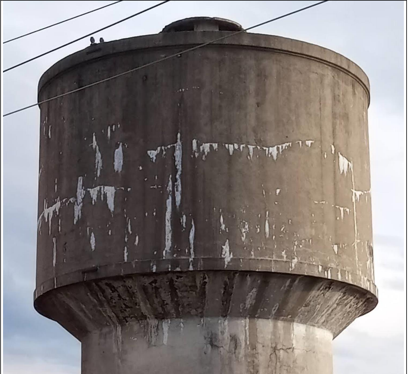
Fig. 7 - Torre piezometrica posta sul lato Ovest dello Scalo – dettaglio del serbatoio
