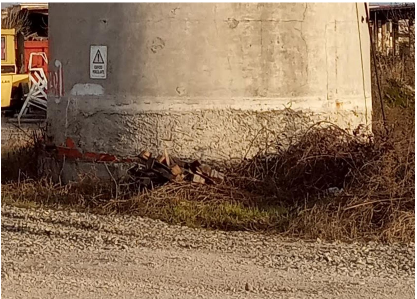
Fig. 5 - Torre piezometrica posta sul lato Est dello Scalo – dettaglio della base
