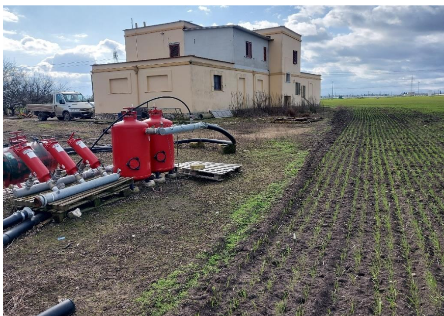
Figura 16: Pompe per tiraggio acqua dalla vasca ubicata sul lato nord-ovest della vasca, tra la vasca e l'edificio vicino
