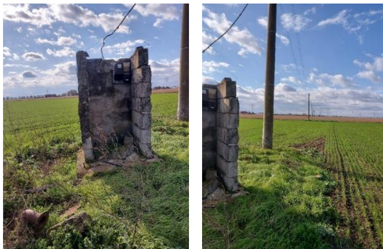
Figura 9: Pozzo in disuso e linea dedicata
