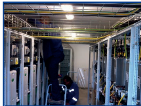
Cabina Inverter IZVIN (Romania)
