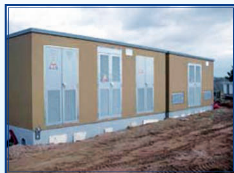
Impianto Fotovoltaico - Kourtesi (Grecia)
