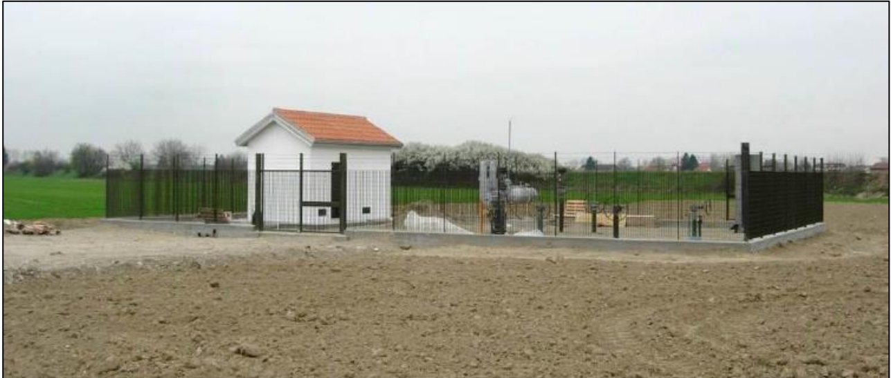
Foto 8.1/A: esempio di impianto di linea: edificio B5 tinteggiato di bianco recinzione di colore verde RAL n.6014
