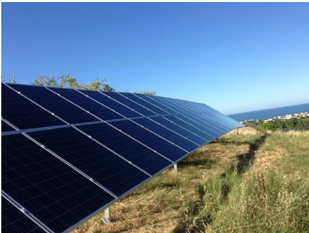
Figura 3.10: Esempio di Struttura di sostegno moduli fotovoltaici
