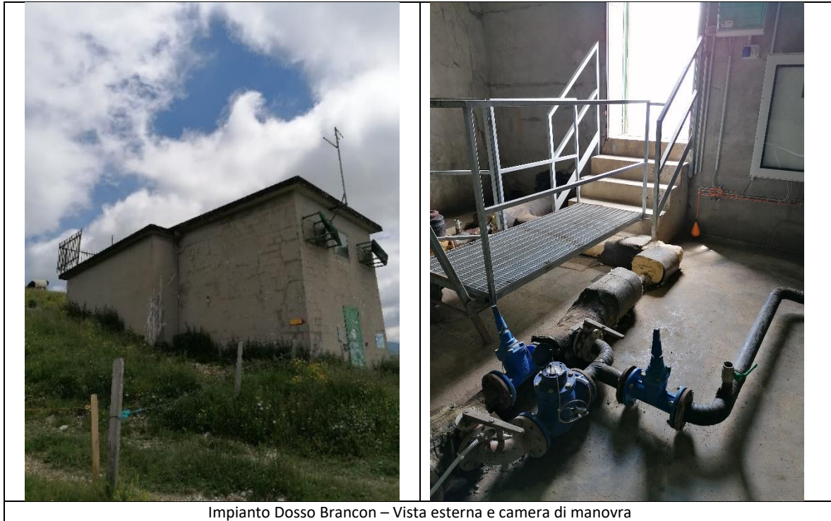
Foto 1: Impianto Tracchi e impianto Dosso Brancon.
