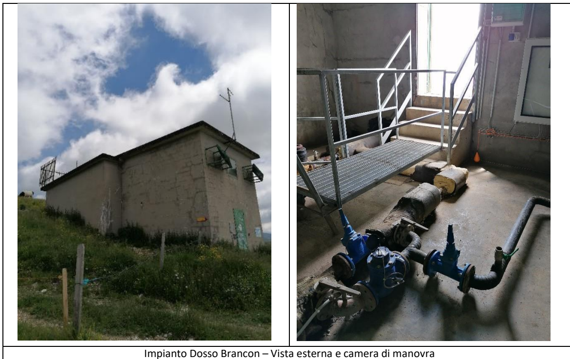
Foto 1: Impianto Tracchi e impianto Dosso Brancon.
