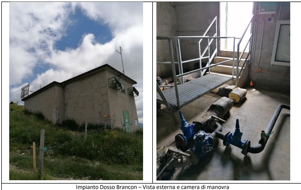
Foto 1: Impianto Tracchi e impianto Dosso Brancon.
