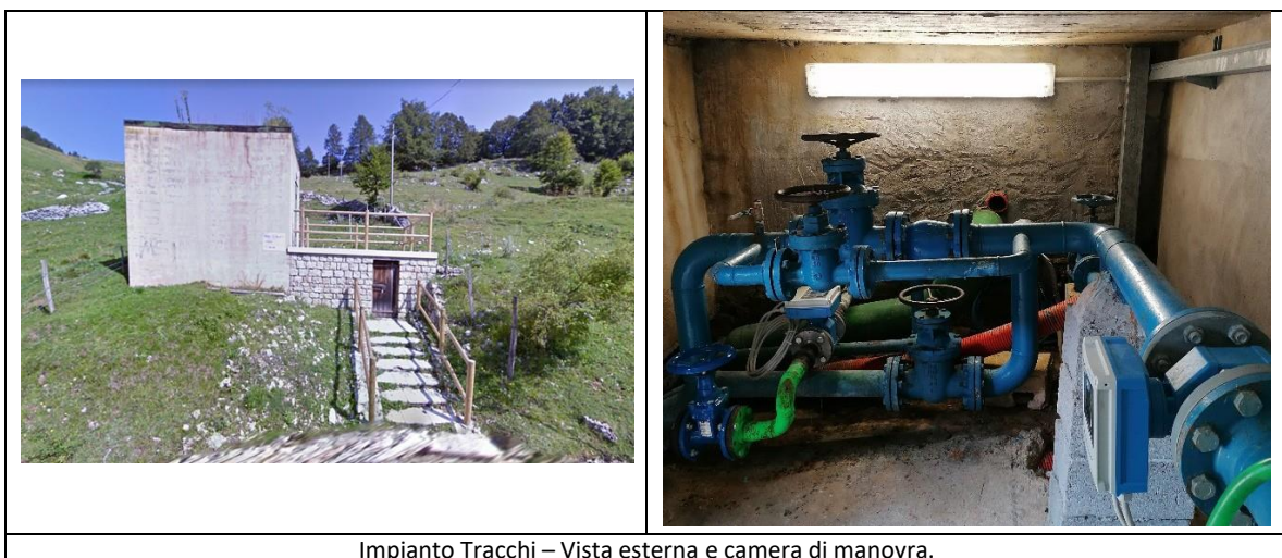
Impianto Tracchi – Vista esterna e camera di manovra.
