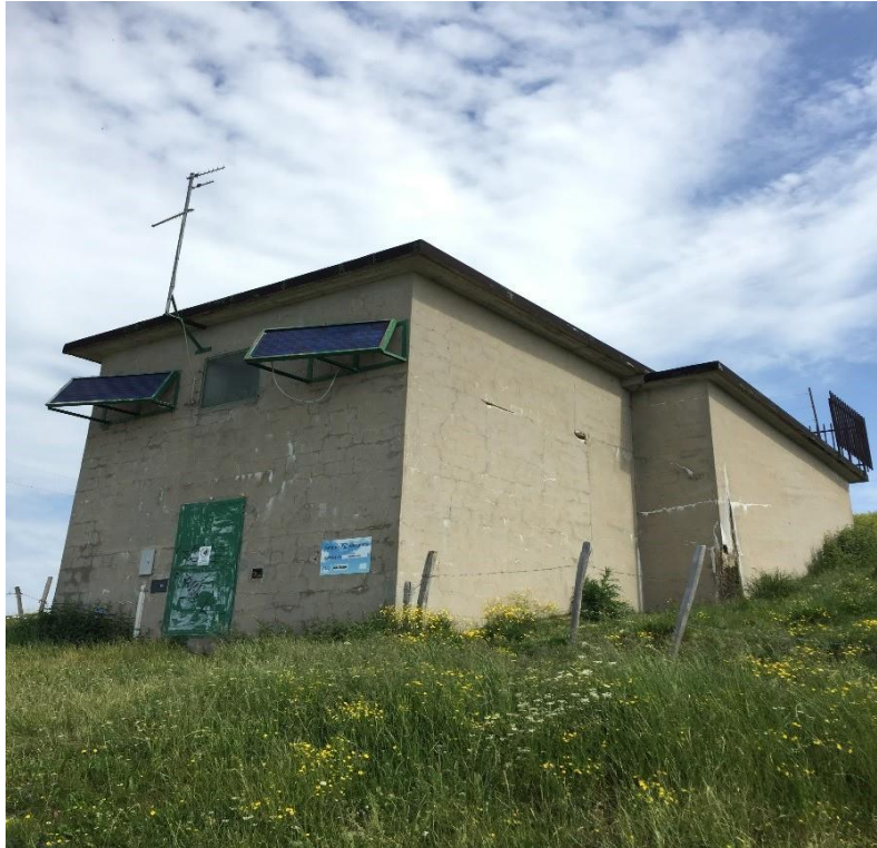
Foto 5: Serbatoio Dosso Brancon
