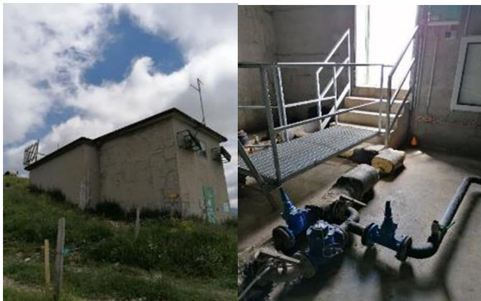
Figura: serbatoio Dosso Brancon
