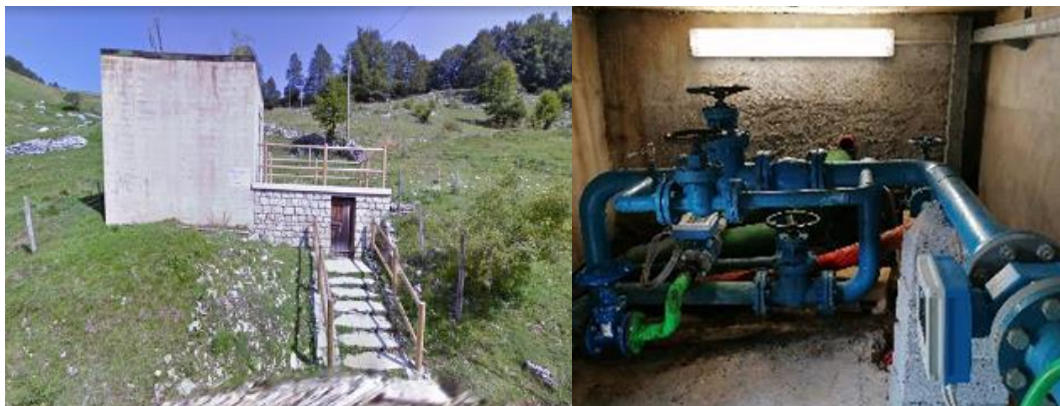
Figura: serbatoio Malga Tracchi
