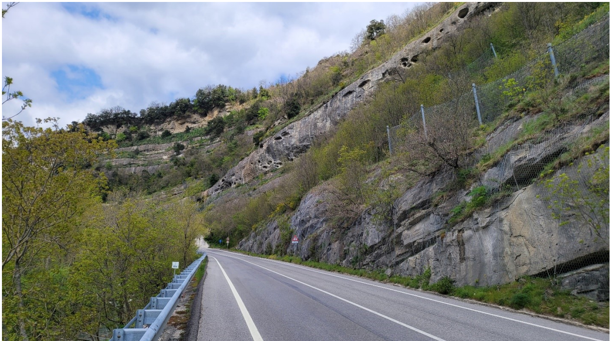
Figura 12 - Ripresa fotografica della S.S.4 nel tratto di collegamento tra la galleria di "Valgarizia" e quella di progetto.
