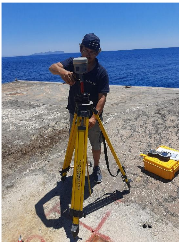
Figura 7 – Isola di Marettimo (TP): Materializzazione di un caposaldo di cantiere e installazione della base per l'esecuzione del rilievo in prossimità del molo nuovo.
