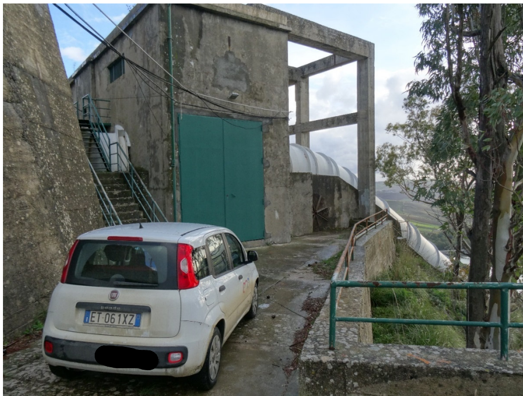
Figura 9: Camera valvole e partenza delle condotte forzate.
