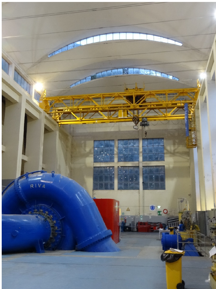
Figura 30: Centrale di Guadalami: Gr. 2 (in primo piano la turbina).
