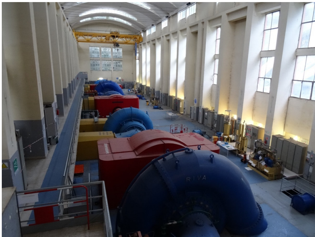
Figura 23: Centrale di Guadalami: vista della sala macchine.
