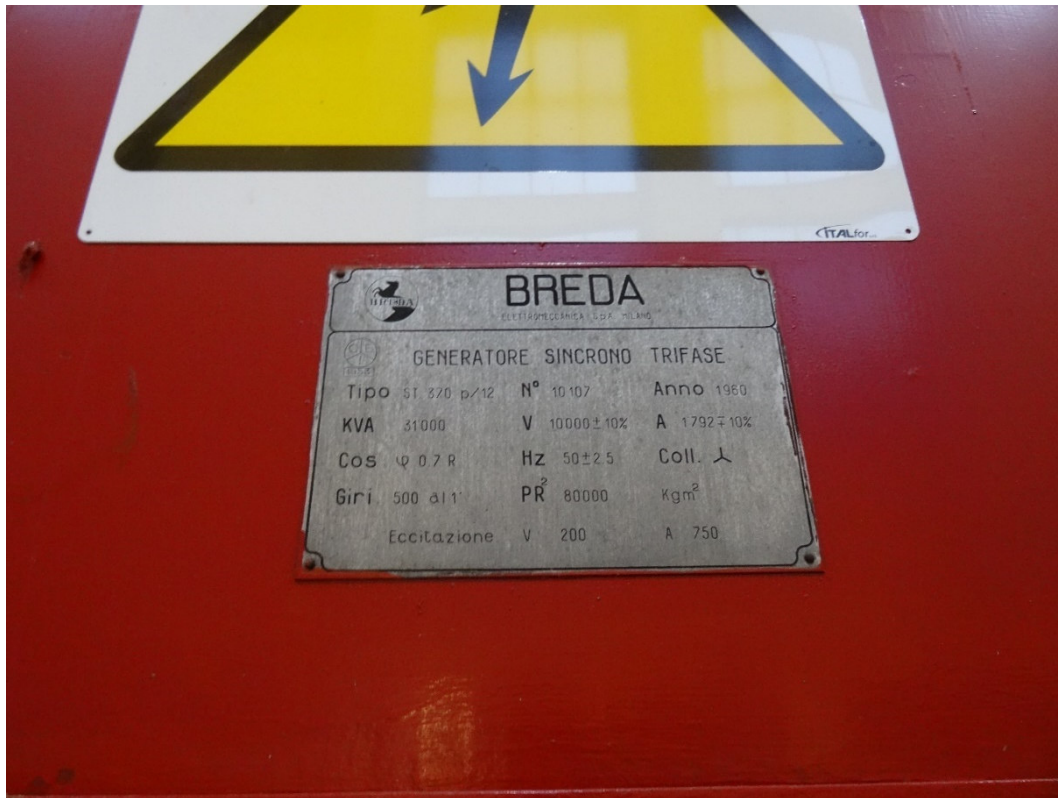
Figura 33: Centrale di Guadalami: dati di targa del generatore sincrono trifase Gr. 3.
