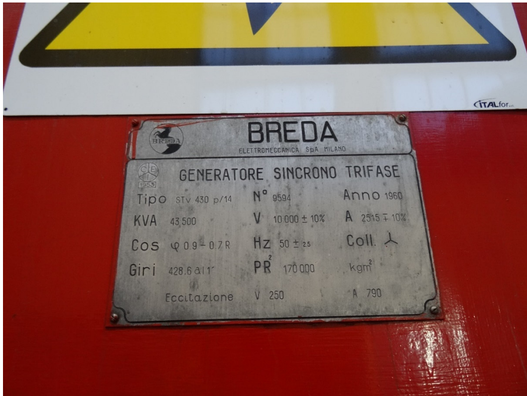
Figura 34: Centrale di Guadalami: dati di targa del generatore sincrono trifase Gr. 2.
