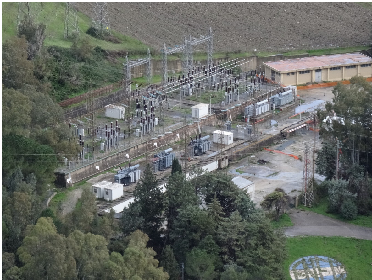
Figura 45: Impianto di Guadalmi: cabina di trasformazione MT/AT con evidenza dei trasformatori.
