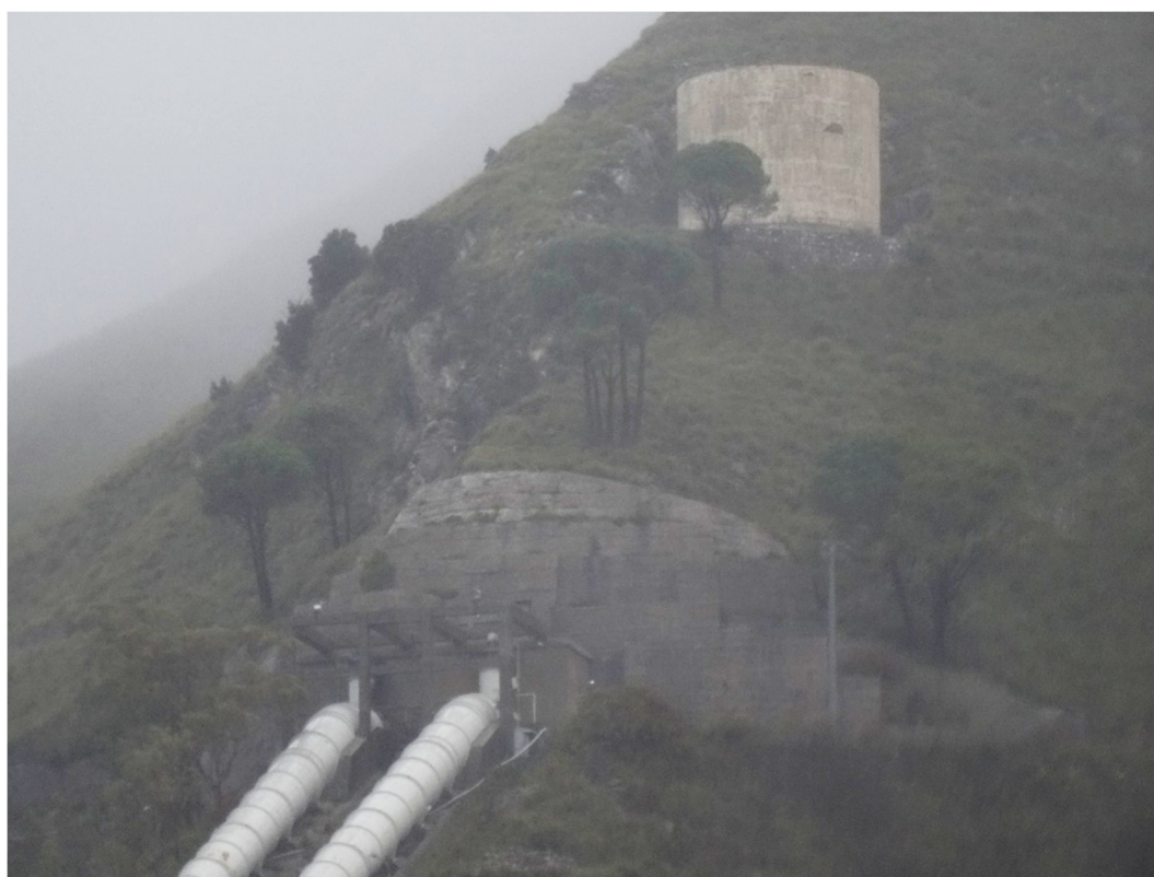
Figura 8: Pozzo piezometrico e camera valvole: vista dal lago di Guadalmi.
