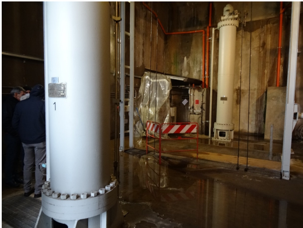
Figura 4: Presa di Lago degli Albanesi: servomotori delle paratoie di presa.
