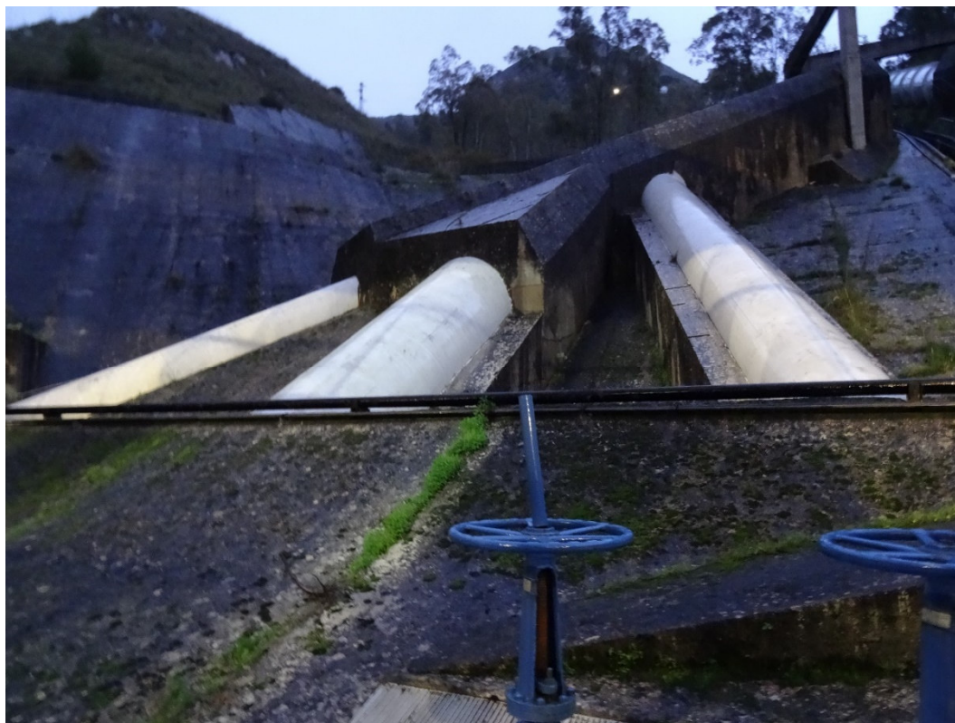
Figura 20: Condotta forzata destra: triforcazione ed entrata in centrale.
