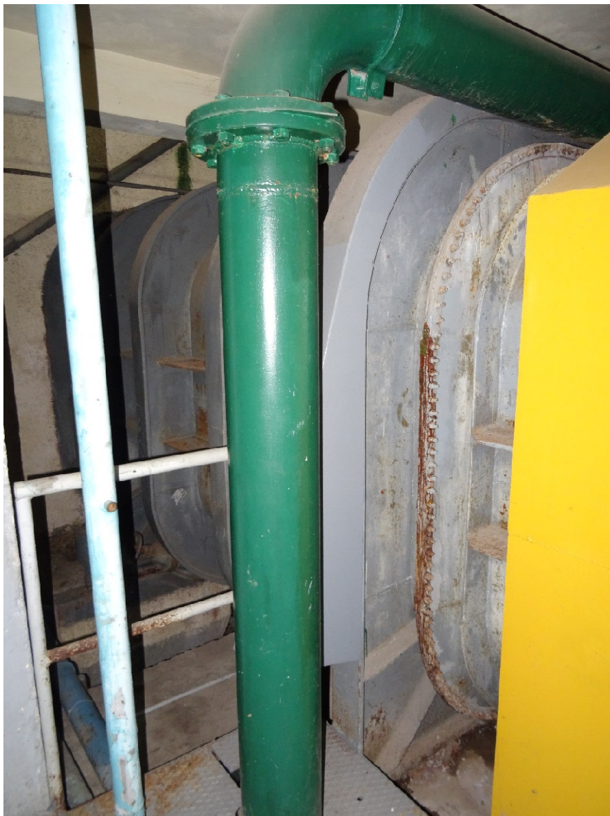
Figura 27: Centrale di Guadalami: in secondo piano collegamento dell'uscita turbina Gr. 3 al canale di scarico (in colore grigio).
