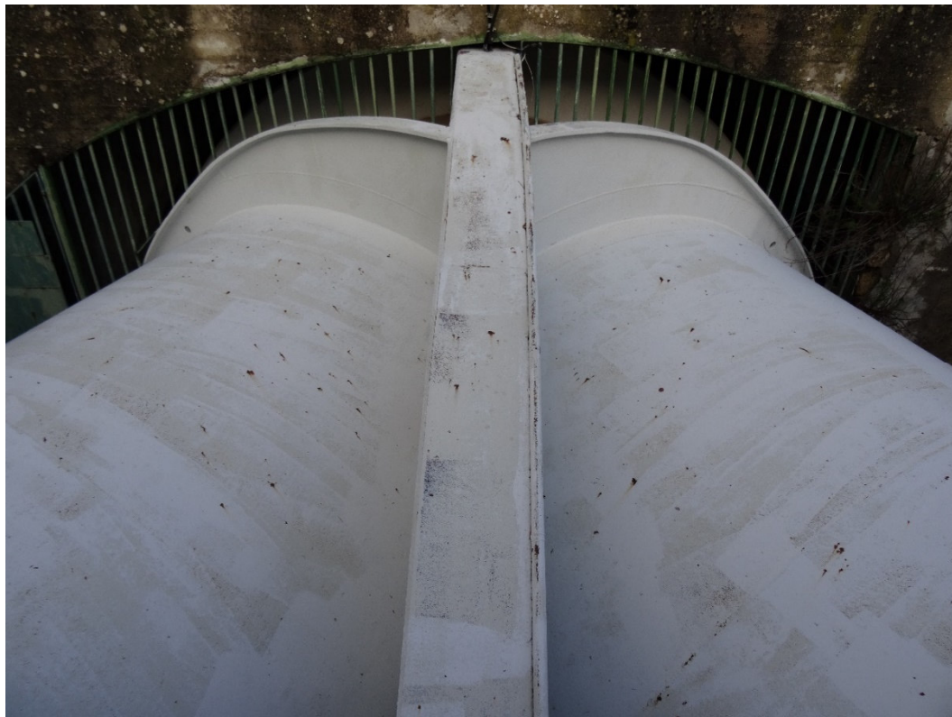
Figura 13: Camera valvole: biforcazione della condotta forzata sul lato a monte.
