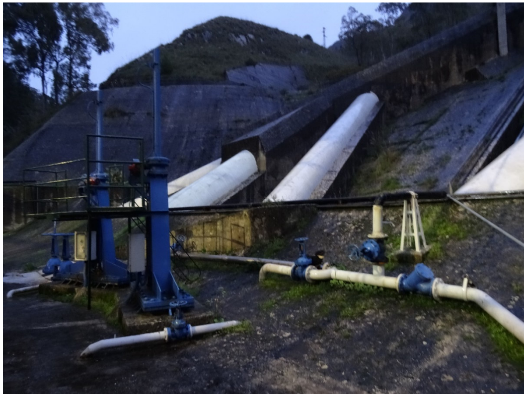
Figura 19: Condotte forzate: paratoie di sezionamento del gruppo GR3.
