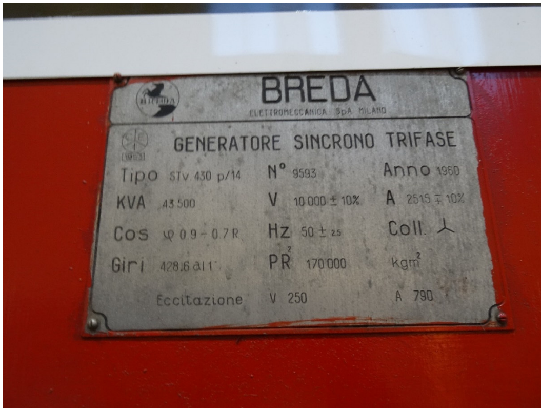
Figura 32: Centrale di Guadalami: dati di targa del generatore sincrono trifase Gr.1.
