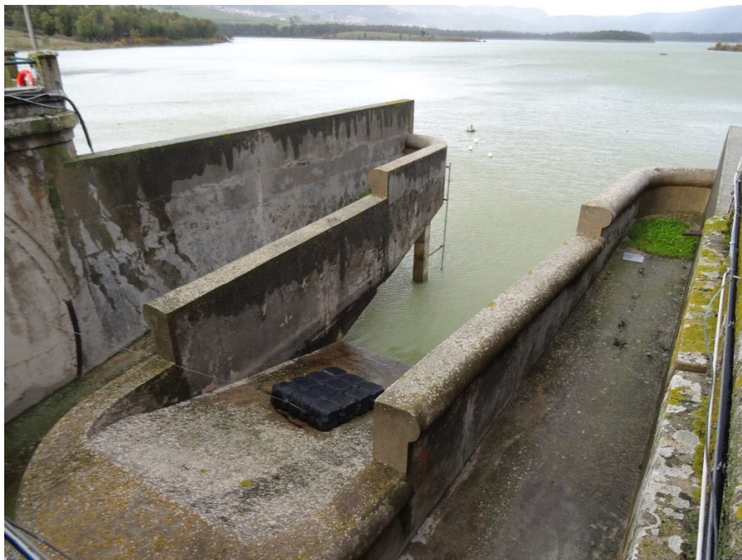
Figura 3: Diga Piana degli Albanesi: scarico di superficie, con soglia a gradoni di diversa quota.
