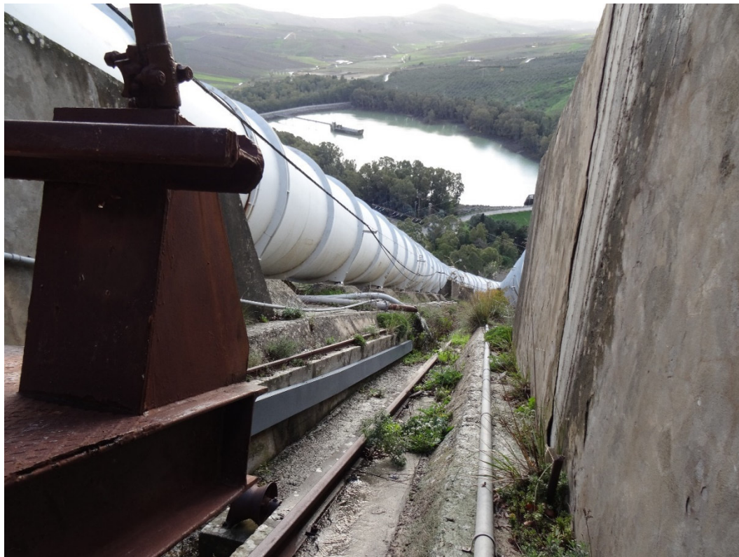
Figura 17: Condotte forzate e piano inclinato di servizio. Vista verso il lago di Guadalami.
