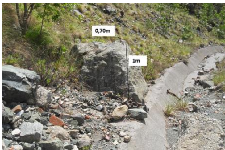
Figura n.4.1 – Blocco di distacco rilevato all'estremità del canale di scolo
