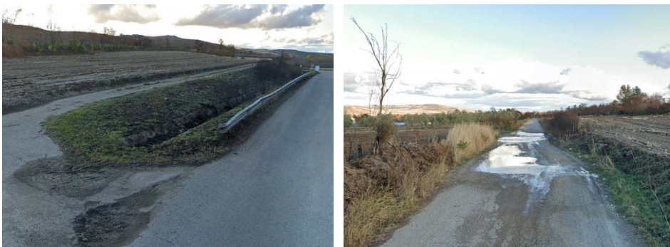
Figura 6. Le vecchie canalette di drenaggio sono colme di materiale, l’asfaltatura della strada è spesso assente, la sede è lastricata di buche per tutto il tratto tra lo svincolo SS655 e la diga del Basentello. Non è presente segnaletica.
