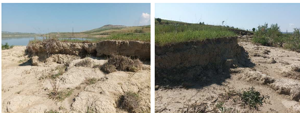
Figura 9. I segni di arretramento delle sponde del lago in orografia sinistra sono evidenti. Nell'ambito delle operazioni di bonifica è possibile intervenire stabilizzando i fronti di sponda ad esempio con delle palificate vive o con altre tecniche di ingegneria naturalistica.
