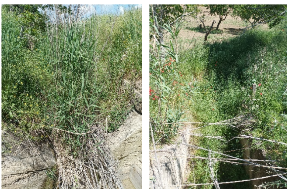
Figura 41. Alcuni salti in calcestruzzo e muri d'ala dei sottopassi stradali lungo l'alto corso del Pentecchia nei pressi del bacino di monte in località Monte Marano.
