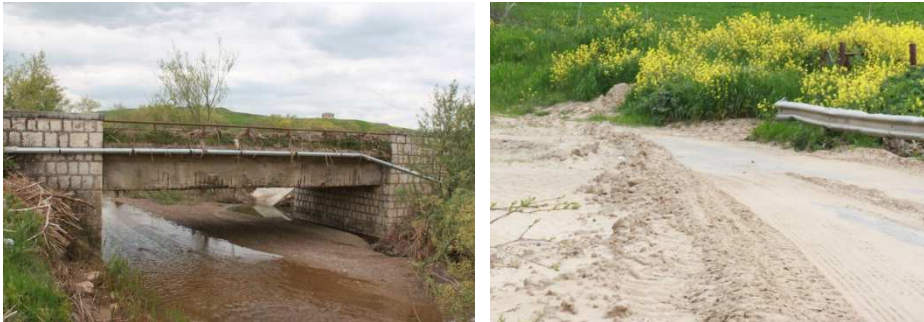
Figura 2. Il ponte sul torrente Pentecchia dopo l'alluvione del 2011 ed un'immagine della sede stradale invasa dal fango.
