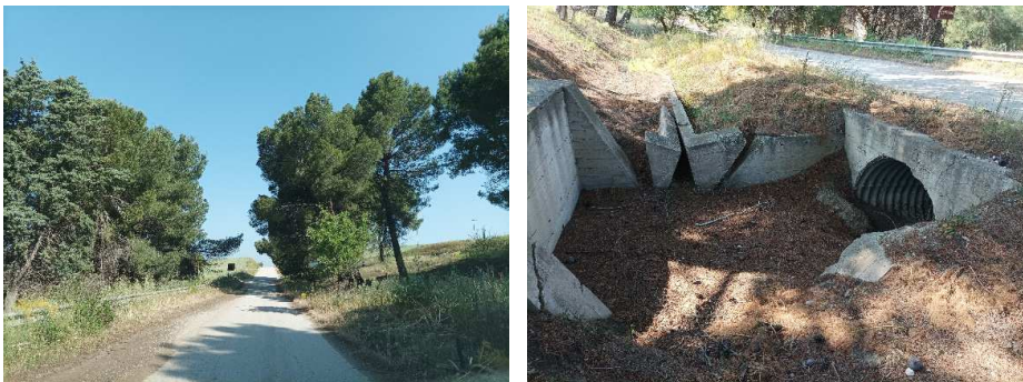
Figura 46. Bypass idraulico lungo la strada poderale per contrada Basentello nei pressi degli edifici di servizio della diga del Basentello. Si nota come le strutture siano in un pessimo stato di conservazione e siano caratterizzate da una probabilità di ostruzione in caso di evento relativamente elevata.
