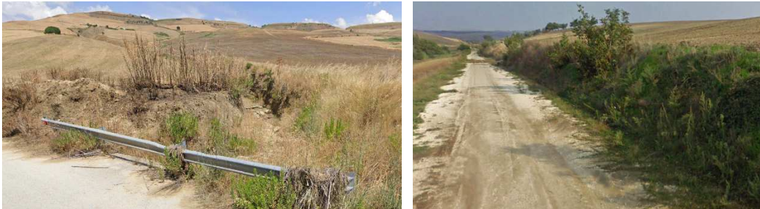
Figura 44. Il fossato non regimato che degrada dai versanti in erosione nei pressi della diga di Serra del Corvo (a sinistra) e piccolo canale di drenaggio lungo la strada di accesso al sito dove verrà realizzato l'invaso di monte (a destra).
