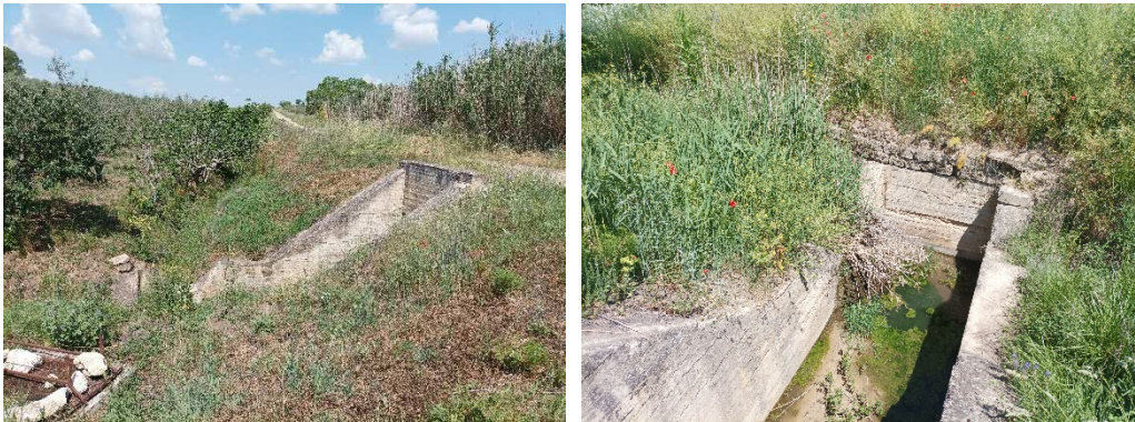
Figura 40. Lungo l'alto corso del torrente Pentecchia sono presenti alcuni tratti completamente cementati ed interrati che non garantiscono condizioni idrauliche ottimali di deflusso.
