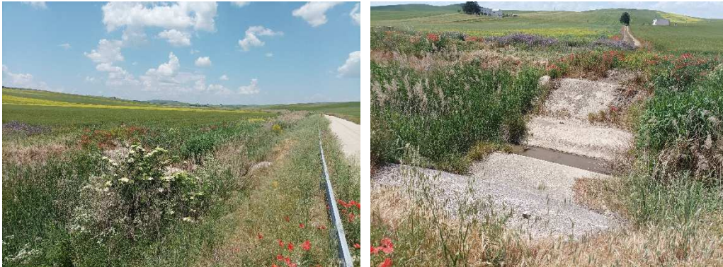
Figura 39. Lungo il corso del canale Roviniero sono presenti alcuni tratti completamente cementati con salti di fondo non sormontabili dalla fauna ittica.
