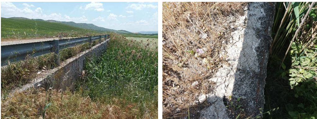
Figura 37. Uno degli attraversamenti stradali lungo il canale Roviniero, la cui luce utile è notevolmente parzializzata dai depositi solidi e la cui struttura è ammalorata.
