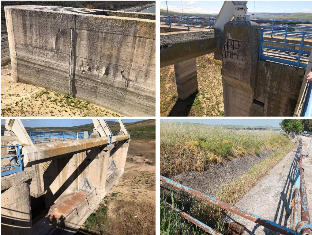
Figura 35. Strutture ammalorate presso l'opera di presa e gli sfioratori superficiali della diga del Basentello, oggi ancora smontati e non in esercizio. Anche i canali di regimazione delle acque a bordo diga non sono mantenuti e versano in condizioni idrauliche assolutamente non funzionali.
