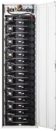
Figura 3 - Esempio rack batterie
